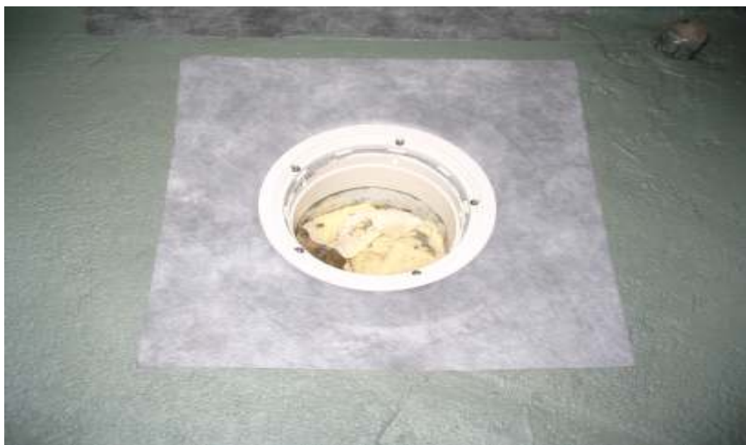
KUVIO3 Lattianvesieristuksen kaivokappale asennettuna
