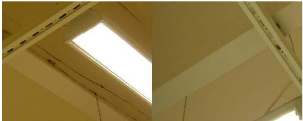
KUVIO 50. Reiän aiheuttama halkeama palkissa
