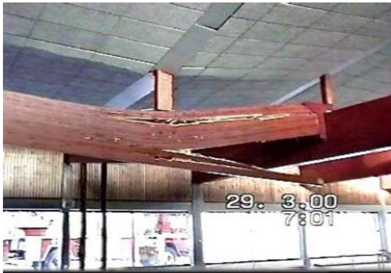
KUVIO 20. Rikkoutunut liimapuupalkki Iisalmen uimahallissa (Onnettomuustutkintakeskus 2000.)
