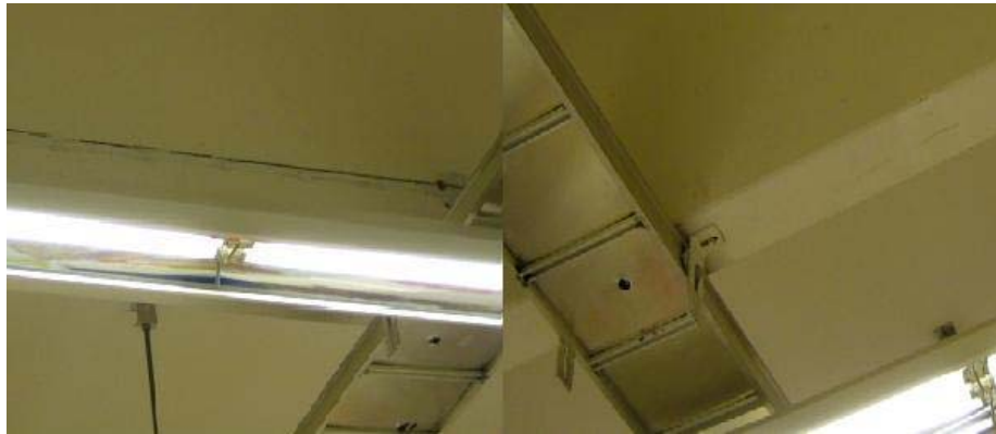
KUVIO 49. Reiän aiheuttama halkeama palkissa
