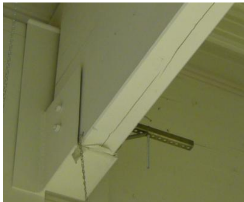
KUVIO 48. Teräskenkäliitos ja halkeama palkin alapinnassa
