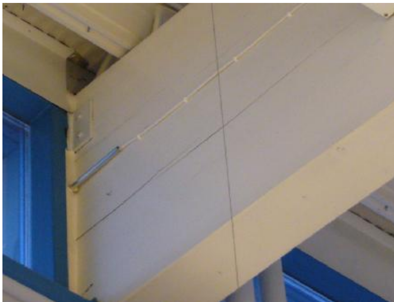
KUVIO 56. Kosteusvaihteluiden aiheuttamat halkeamat
