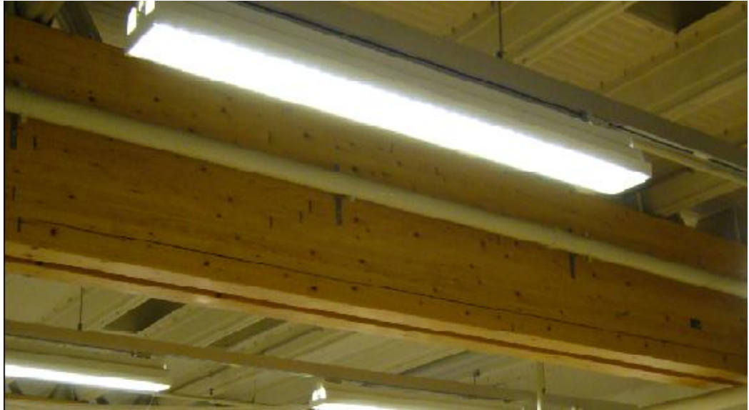
KUVIO 53. Palkin alareunassa sijaitseva pitkä halkeama
