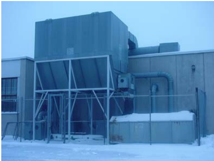
Kuva1. Valumallin valmistuksen, puuosaston koneistussalin ja kokoonpanosalin purunpoistojärjestelmän suodatinyksikkö sekä purukontti.
