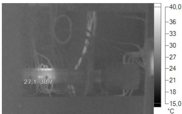
Kuva 1. Komponenttien lämpötilaero on noin 3 °C.
