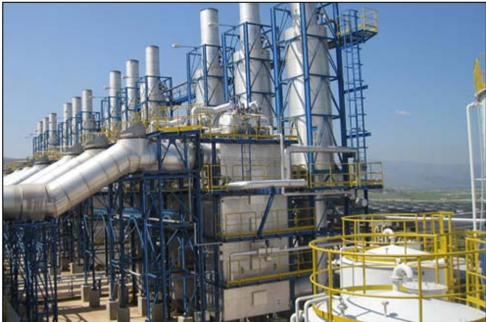
Kuva 1. Alfa Laval Aalborg, Rauman kattiloita maailmalla. (Alfa Laval esittelymateriaali 2014)
