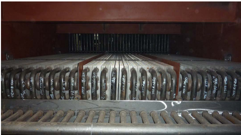
Kuva 25. Jakolevyt putkirekisterin välissä
