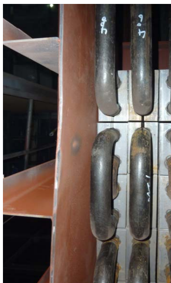
Kuva 27. Kattilan kuorirakenteen seinämä liian lähellä putkipakettia
