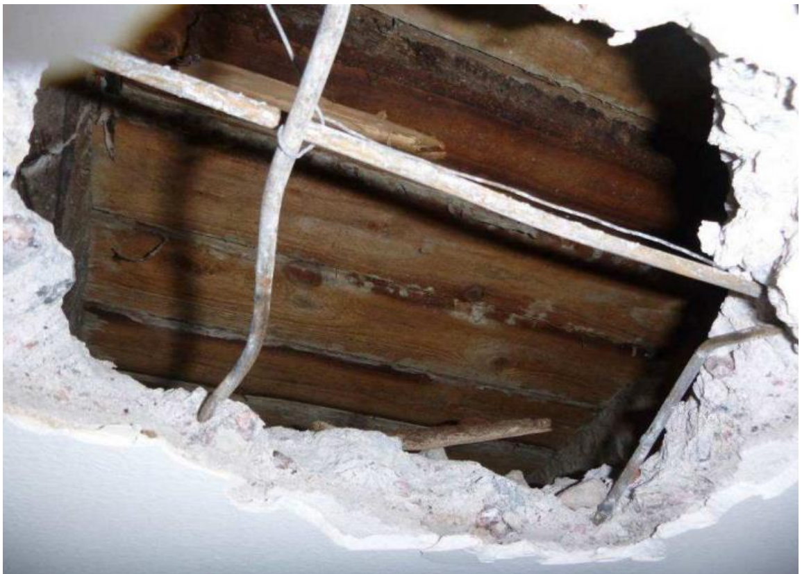
Kuva 6. Välipohjan rakenteen avaus kunnan määrittämiseksi. Muottilautojen reunoissa on havaittavissa kosteuden aiheuttamaa tummentumaa
