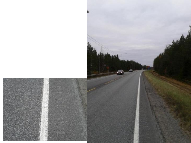
V2S1, K4(kuva pv. 17.10.-14), (Spray +0,8mm.13.9.-14)
