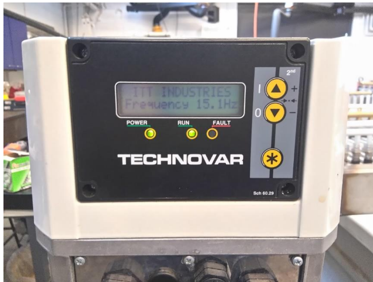
KUVA 17 Kiertopumpun taajuusmuuttaja (Valokuva Iiro Nevalainen)
