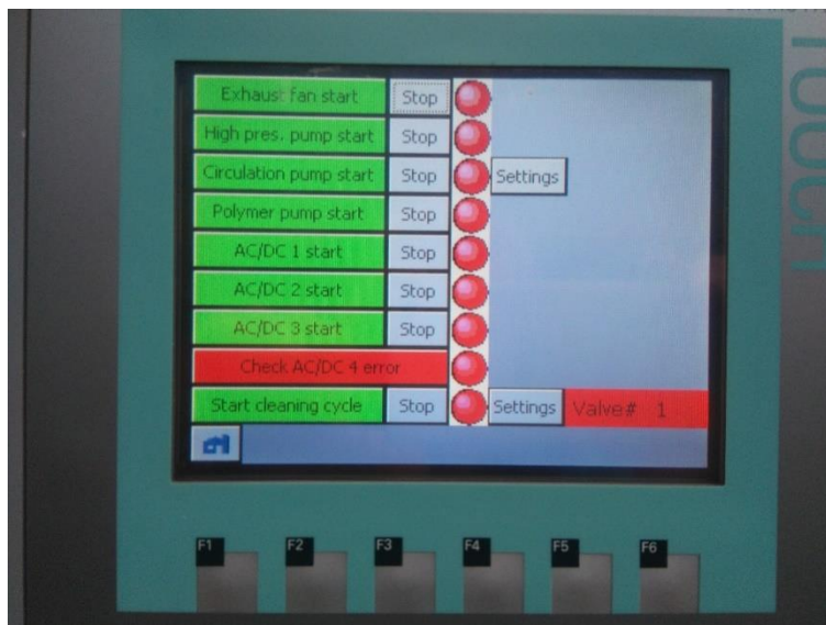
KUVA 16 Poistopuhallin sammutettu, tasasuuntaajassa virhe (Valokuva Iiro Nevalainen)
