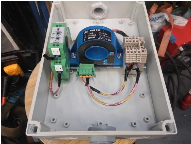
KUVA 13 Virranmittauskeskus (Valokuva Iiro Nevalainen)
