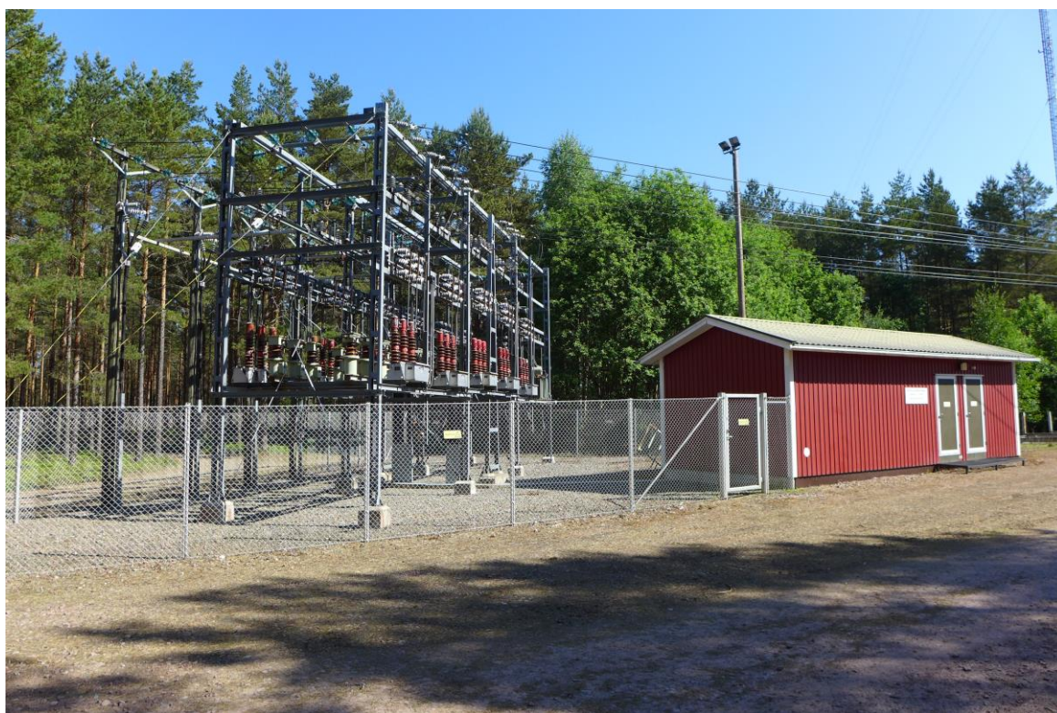
Kuva 4. Ristolan 20kV:n kytkinasema
