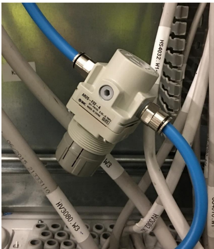
Kuva 11. Paineensäädin asennettuna SICK FW102:n puhdistusilman syöttöön
