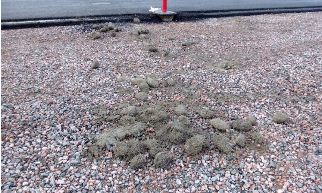
Kuva 49. Betonipumpun letkun tukoksia, niin sanottuja ”terässiilejä”.
