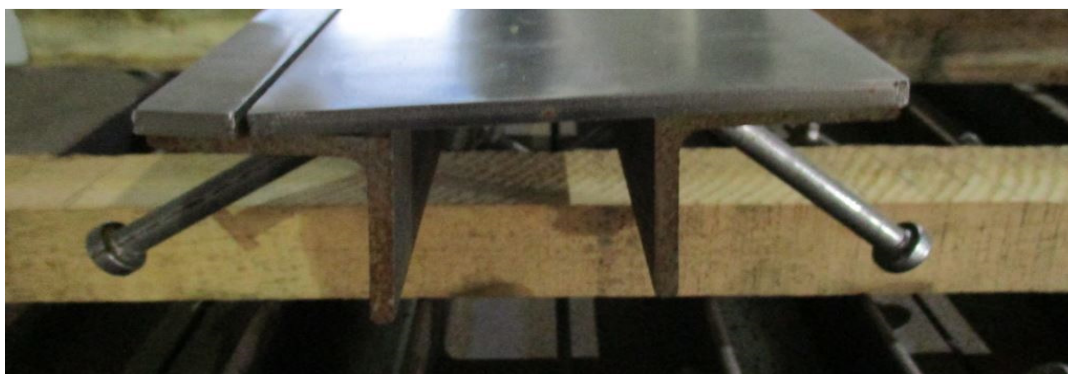
Kuva 31. Kuvassa näkyy eristetty kynnyks. Kynnyksessä ei ole lämmitykselle varausta, eikä irroitettavaa päälilevyä lämmityksen huoltoa varten.
