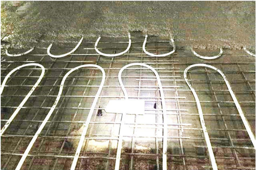
Kuva 55. Rikki menneen lattialämmityspotken alle on laitettu merkiksi pala finnfoam levyä.
