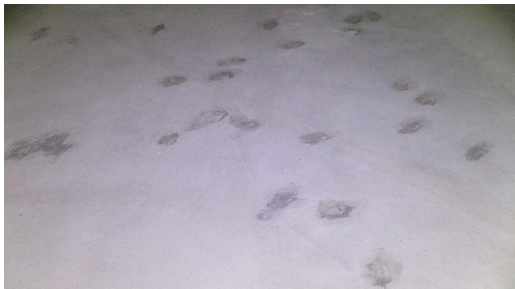
Kuva 56. Pinnasta poistettujen kuitujen paikkausjäljet paistavat betonilattiassa.
