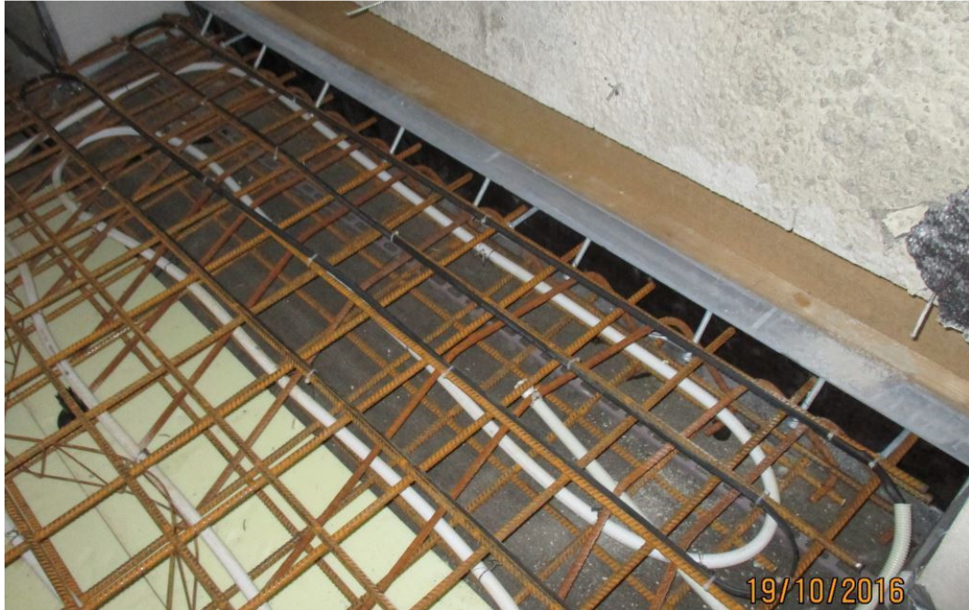
Kuva 45. Lämmitetyn kynnyksen sijaan on laatan reuna lämmitetty pinnasta lämmityskaapelilla. Syvemmällä kiertää vesikiertoinen lämmitysputkisto.
