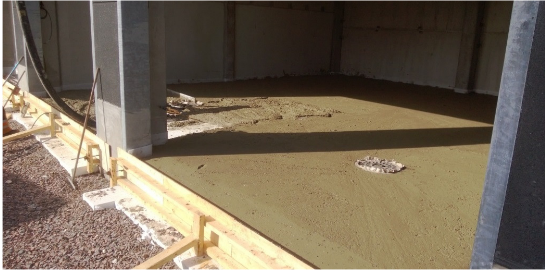
Kuva 51. Aurinko paistaa suoraan juuri valetulle betonilattian pinnalle.
