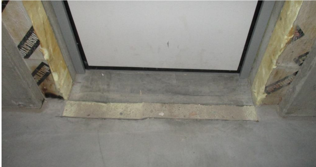
Kuva 58. Oviaukossa lattiat jakava eriste on päistään vajaa luoden kylmäsilan.
