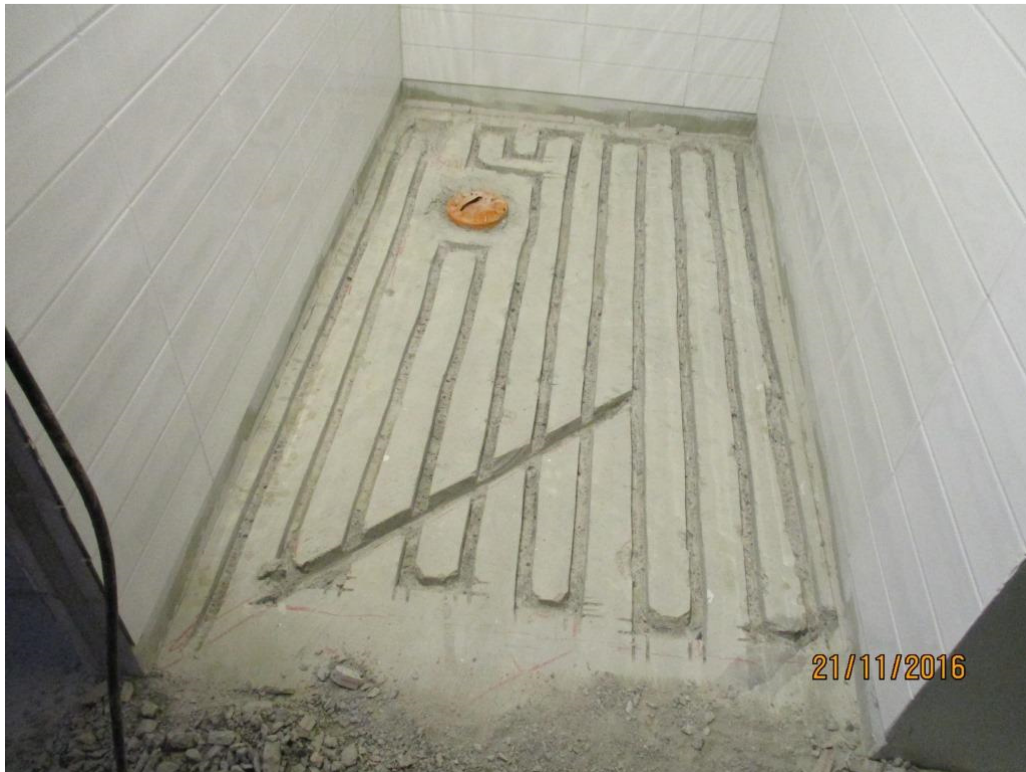
Kuva 50. Jälkeenpäin tehty lattialämmitys, sahaamalla urat betonilattiaan.
