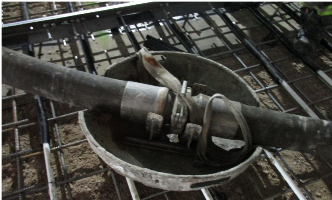
Kuva 43. Pumpun letkun liitoksen suojaus.
