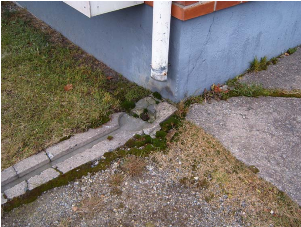
Kuva 14. Syöksytorvet (F43.2.). Betoniset sadevesien poistokourut poistetaan ja rakennukselle rakennetaan asianmukainen sadevesien poistojärjestelmä.
