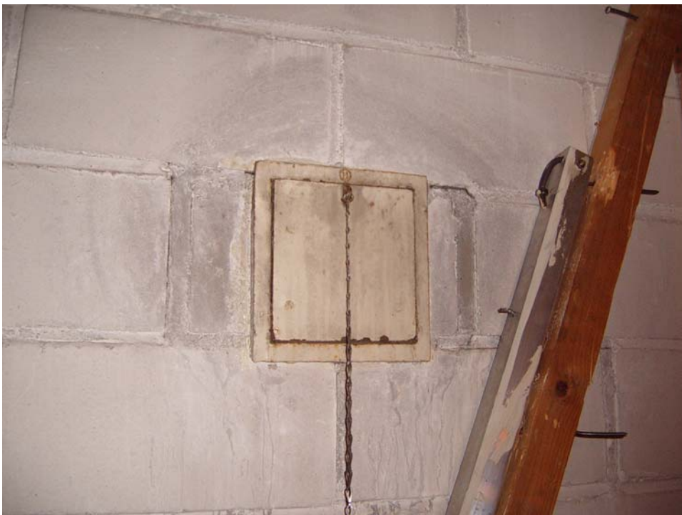
Kuva 22. Uusitaan vanhentuneet ja toimimattomat ilmanvaihtolaitteet.
