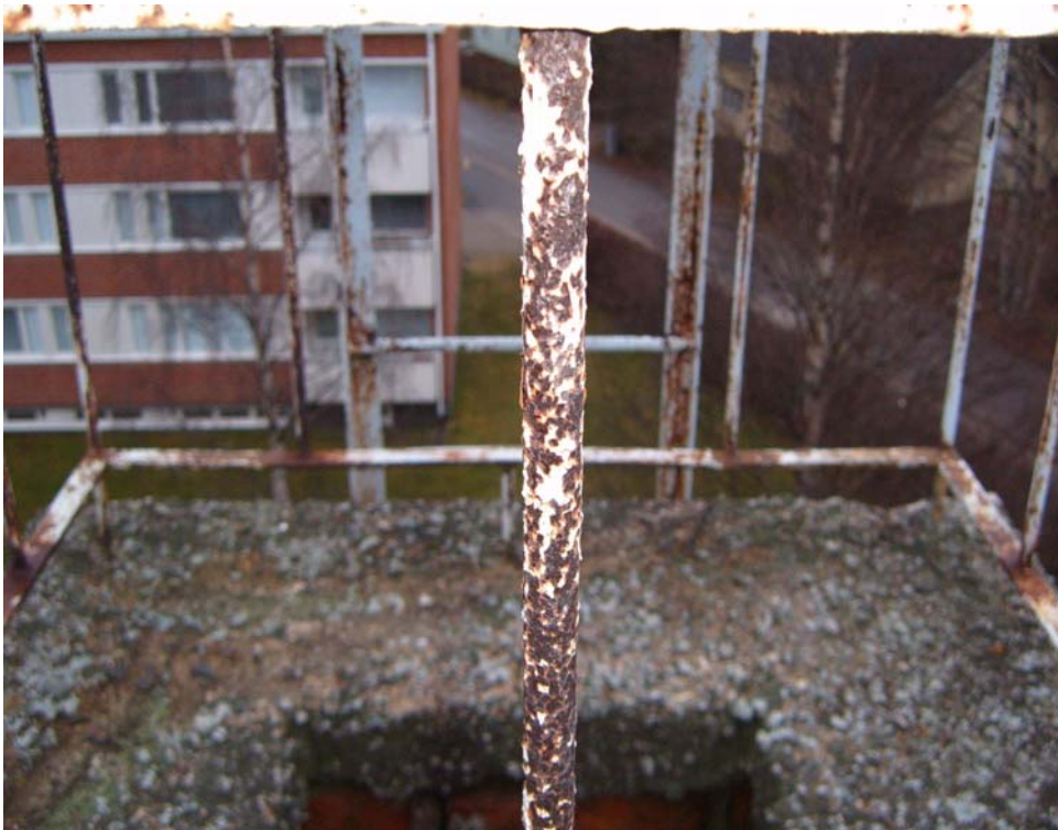
Kuva 10. Ulkoseinän tikkaat (F34.2). Tikkaat maalaus kunnostetaan, asennetaan turvavarusteet valjaita varten tai vaihdetaan tikkaat uusiin asianmukaisilla turvavarusteilla varustettuna.
