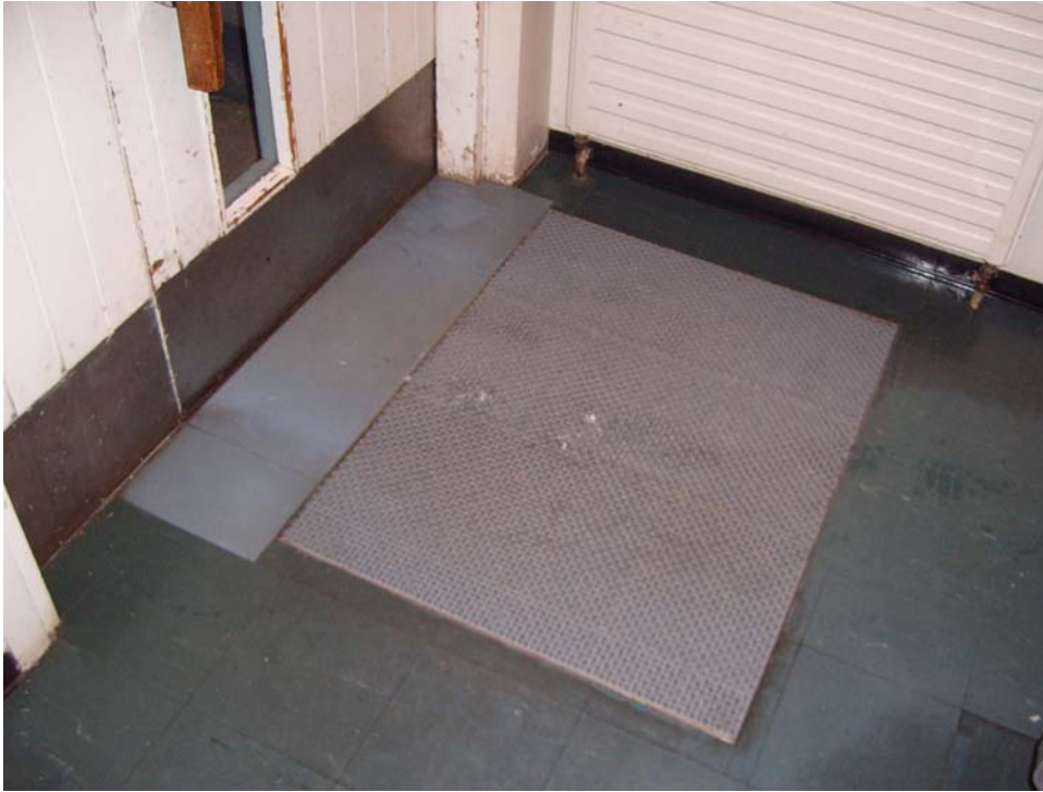
Kuva 15. Yleistilat. Suoritetaan mahdollisen perusparannuksen yhteydessä asbestikartoitus porrastasanteissa käytetyn Linoleum- laattojen asbestiliiman osalta.
