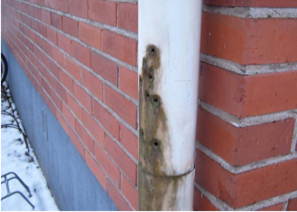
Kuva 13. Syöksytorvet (F43.2.) Kaikki rakennuksen syöksytorvet vaihdetaan uusiin.
