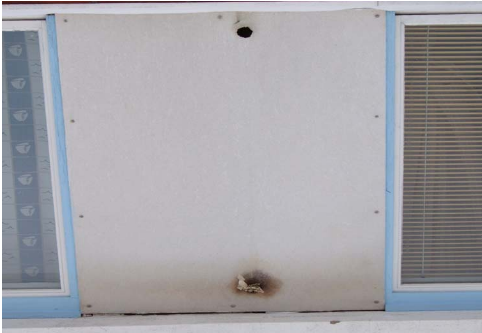
Kuva 7. Levytetyt ulkoseinät (F31.6). Vanhat Minerit- levyt vaihdetaan uusiin asbestittomiin levyihin ja varmistetaan levyn alle riittävä lämmöneristys.
