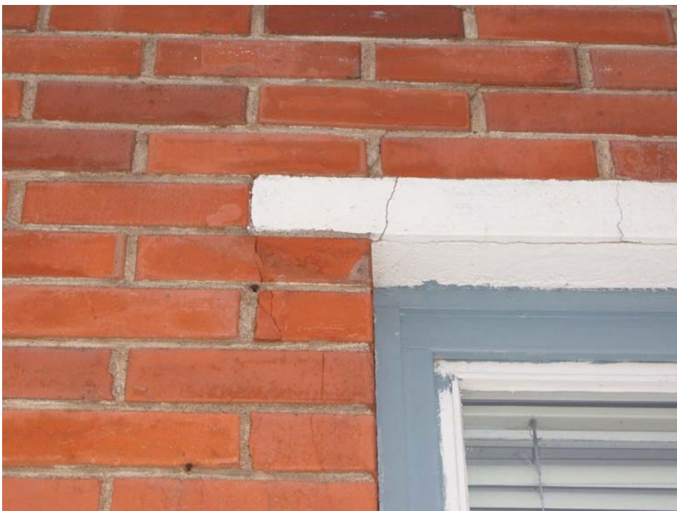
Kuva 6. Rakennusrunko (F2). Selvitetään syy tiiliverhousta kannattelevien leukapalkkien murtumiin jatkotutkimuksilla ja korjataan murtumat.
