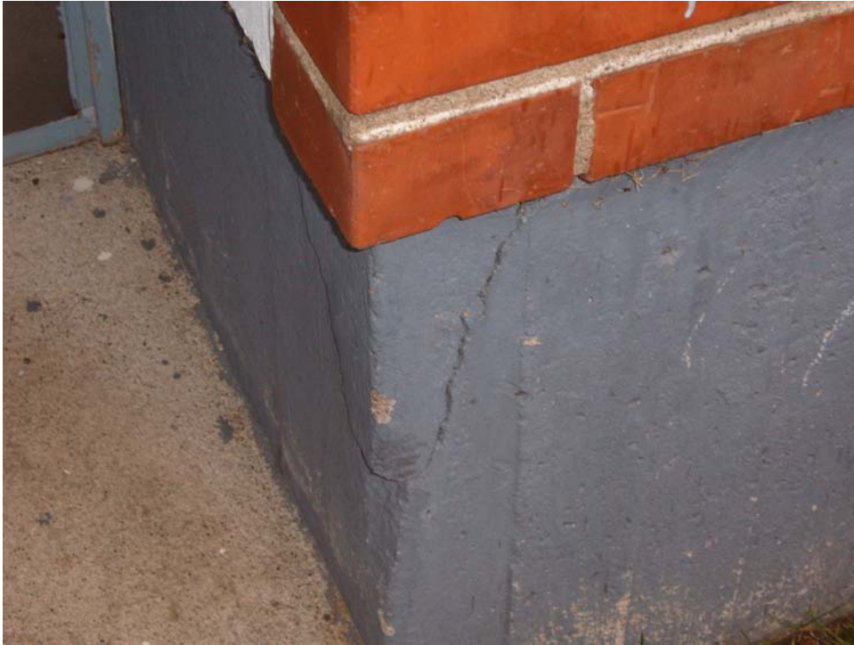
Kuva 5. Perusmuurit, -pilarit, -palkit (F12). Sokkelissa olevat halkeamat puhdistetaan ja paikataan.
