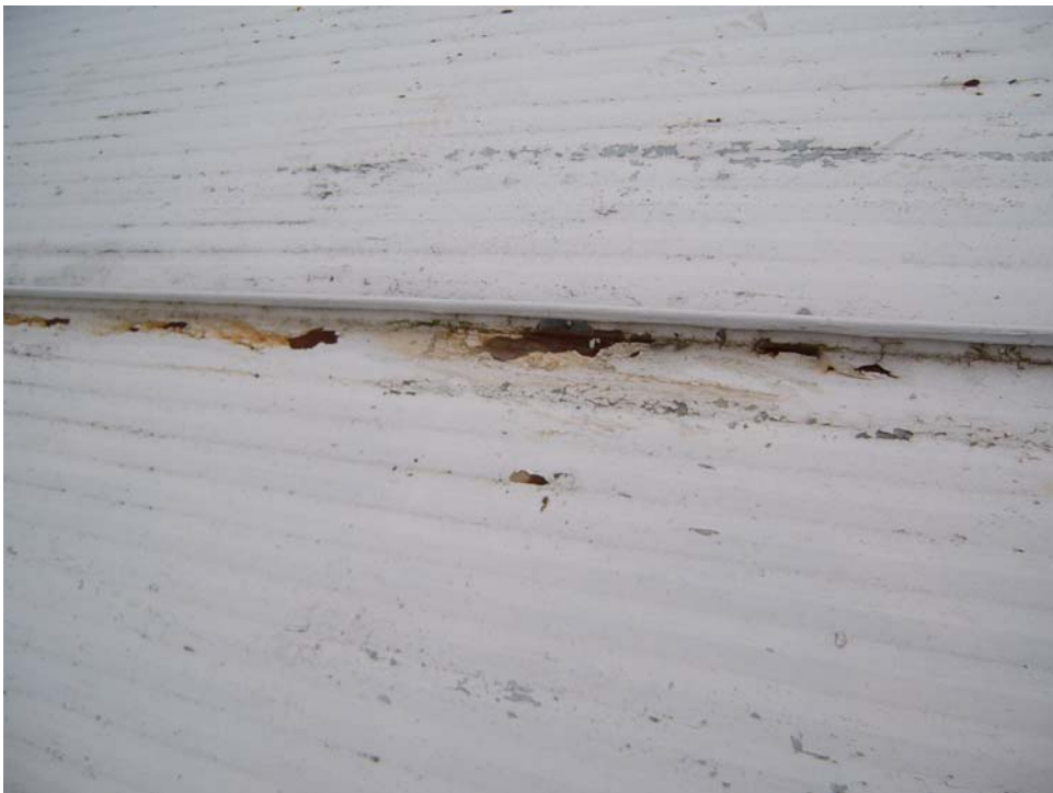
Kuva 12. Vesikatot (F41.1). Puhdistetaan vesikatteesta ruostuneet kohdat ja paikataan ne ruosteenestomaalilla.
