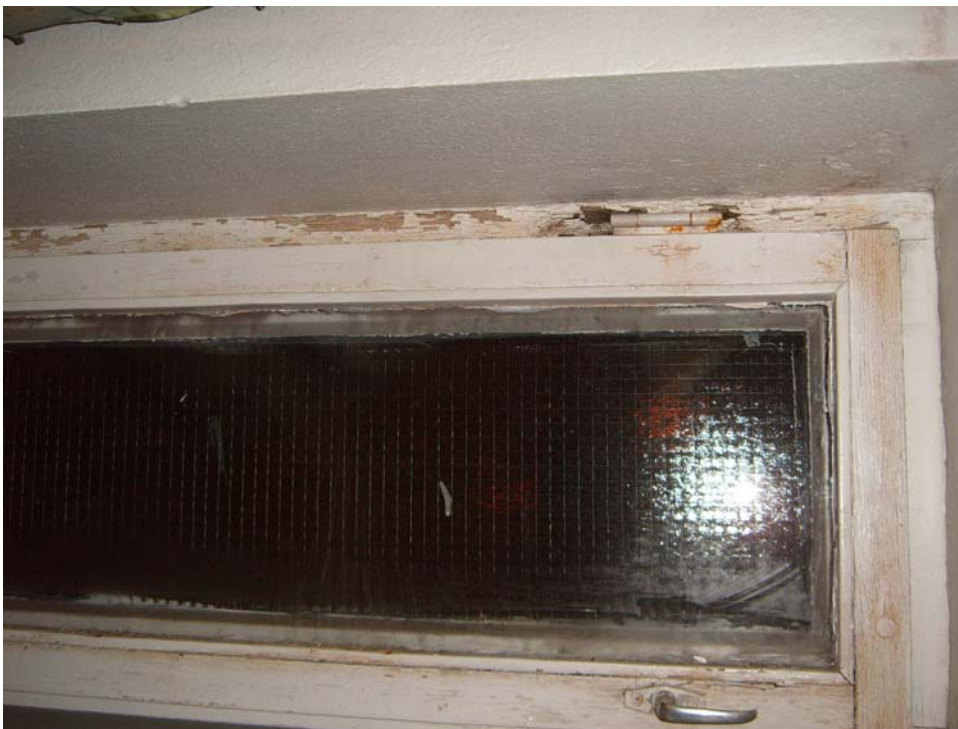
Kuva 8. Ikkunat (F32). Rakennuksen huoneisto- porrashuone ja kellari-ikkunat vaihdetaan uusiin.
