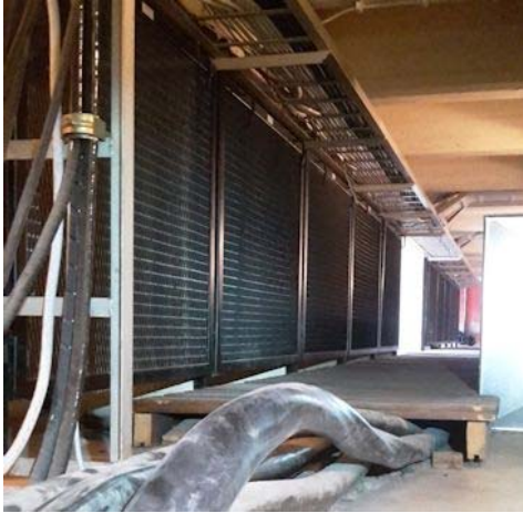
Kuva 6. Kojeiston alapuolinen kaapelitila kennohäkkeineen.
