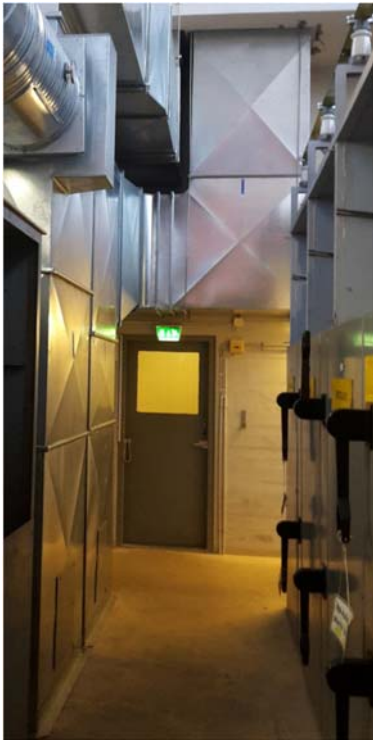
Kuva 5. Ilmastointikoneikko tilan vasemmassa reunassa.
