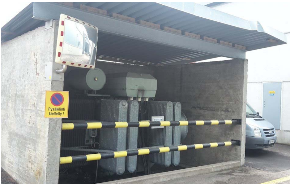
Kuva 8. Blokkimuuntaja ja muuntajakatos.
