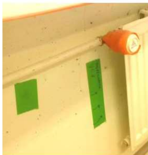
Kuva 8: Halkeama, josta vuotaa ilma
