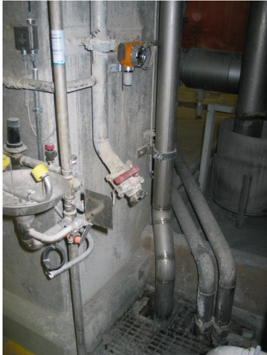
KUVA 13 Pesuhapposäiliön vieressä olevan lähettimen alkuperäinen paikka. Vieressä putket, jotka laskivat kanaaliin. Lähetintä siirrettiin reilu puoli metriä alaspäin kuvan ottamisen jälkeen. (Juha Pölkki, 2010.)
