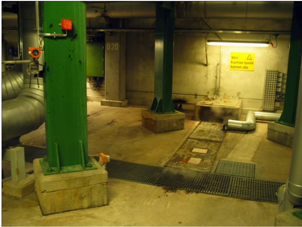
KUVA 18 Uusi mittauspiste. Pilariin asennettu hälytysvalo ja lähetin. Taustalla pilarin takana jakokotelo, johon laitteet kytkettiin. Kaapelihylly oli valoon nähden metrin korkeammalla ja se kulki pylväästä takaseinään ja sieltä edelleen jakokotelolle. Kuvaushetkellä tuloputken venttiili oli hieman auki ja kanaalista tuli höyryä – ja mahdollisesti myös rikkivetyä. Tuloputken pää oli kanaalissa metrin päässä lähettimestä. Vaaleiden luukkujen alla olivat venttiilit. (Juha Pölkki 2010.)
