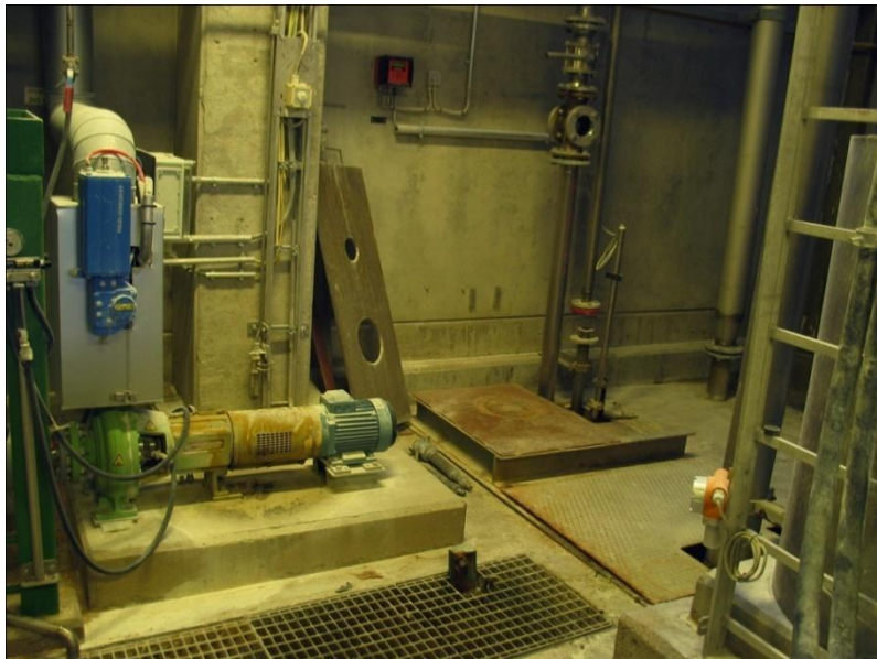
KUVA 15 Uusi lähetin asennettuna paremmalle paikalle. Vanha lähetin oli kiinni va-semmalla olevassa pilarissa. (Juha Pölkki 2010.)
