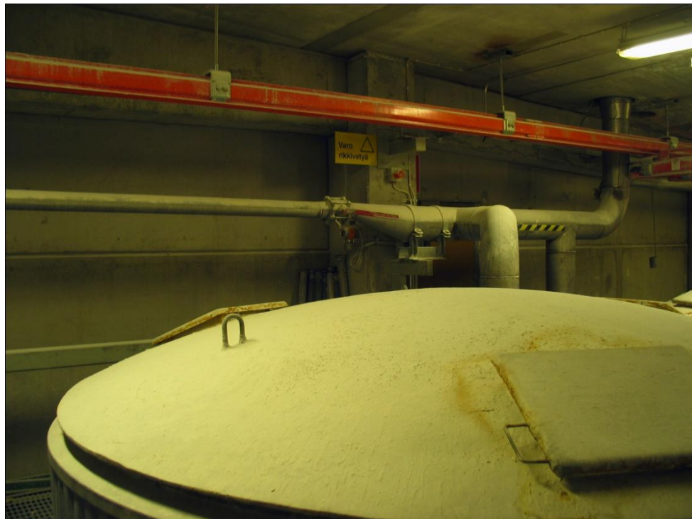
KUVA 25 ECO-säiliö ja lähetin sen takana pilarin kupeessa. Lähetintelineen voisi kiinnittää seinään esimerkiksi rikkivetylähettimen vasemmalle puolelle niin, että se voitaisiin vetää vaakasuorassa kulkevan putken yläpuolelta säiliön päälle. (Juha Pölkki 2010.)
