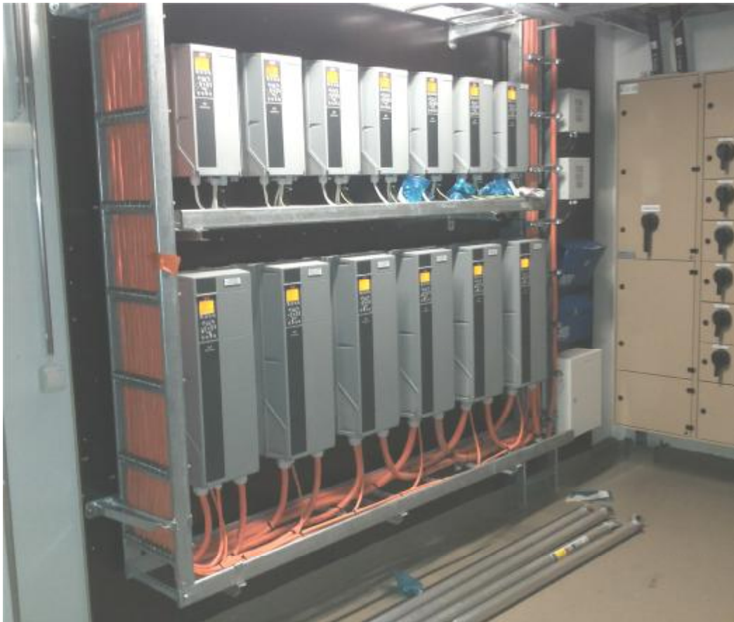
Kuva 18. Taajuusmuuttajat kiinnitettyinä asennusseiniin ja kaapeloituna palonkestävästi.
