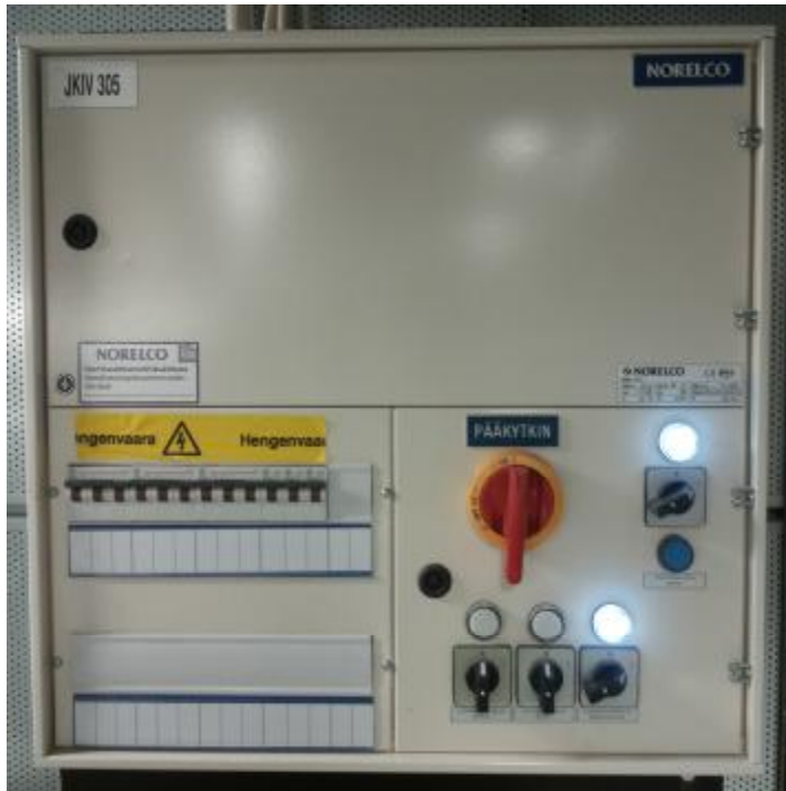
Kuva 11. IV-konekohtainen keskus, jossa pääkytkin toimii laitteiden syötönerotuskytkimenä.
