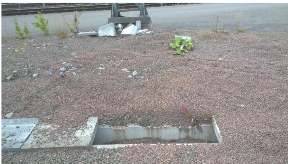
Kuva 8 Kaapelikanavien kansien rikkoutumisesta seuraava ongelma (7.)
