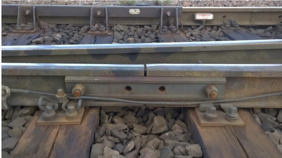
Kuva 3 Sidekiskosta puuttuvat pultit (7.)
