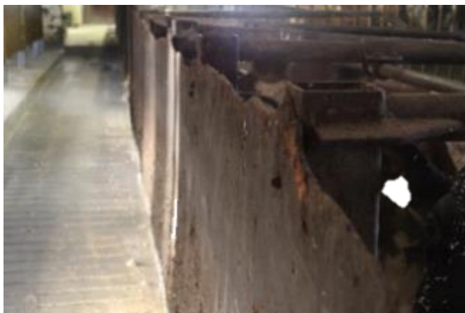
KUVA 2. Kuluneita rakenteita (Siponen 2017-01-20).
