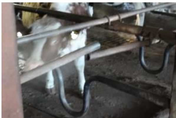
KUVA 4. Rikkinäiset parsirakenteet voivat aiheuttaa vaaran eläimen vahingoittumiselle, joten niistä voi tulla sanktio (Siponen 2017-01-20).
