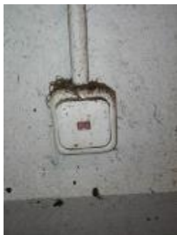
KUVA 18. Suuri määrä pölyä sähkölaitteiden päällä voi olla paloturvallisuusriski (Julkunen 2016-08-01).
