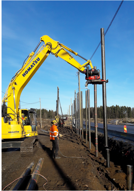
Kuva 16. Katkaistavaa paalua tuettiin kaivinkoneen pihdeillä. Paalujen yläpää mitattiin ja jokaisesta 12 metrisestä paalusta saatiin 2-3 kappaletta oikeanmittaisia paaluja. Myös lähellä olevat sähköjohdot vaativat työn suoritukselta erityistä tarkkuutta.
