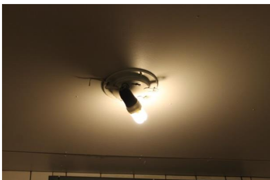
Kuva 173. Miesten Wc 085, kupu puuttuu
