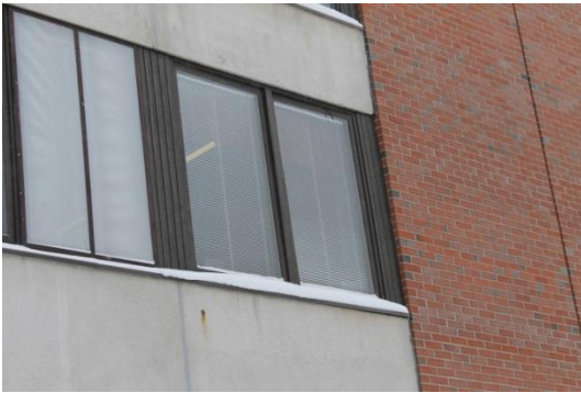
Kuva 52. Rapautuma julkisivulla länteen
