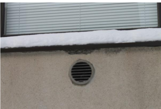
Kuva 44. Rapautumia julkisivussa itään
