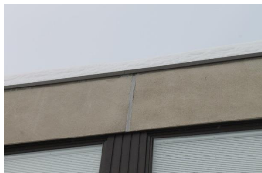
Kuva 45. Halkeama julkisivussa itään
