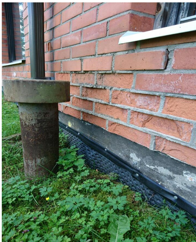
Kuva 4. Laajennusosan pohjoispäädyn tuuletusputken kohdalla tiiliseinä on rappeutunut.
