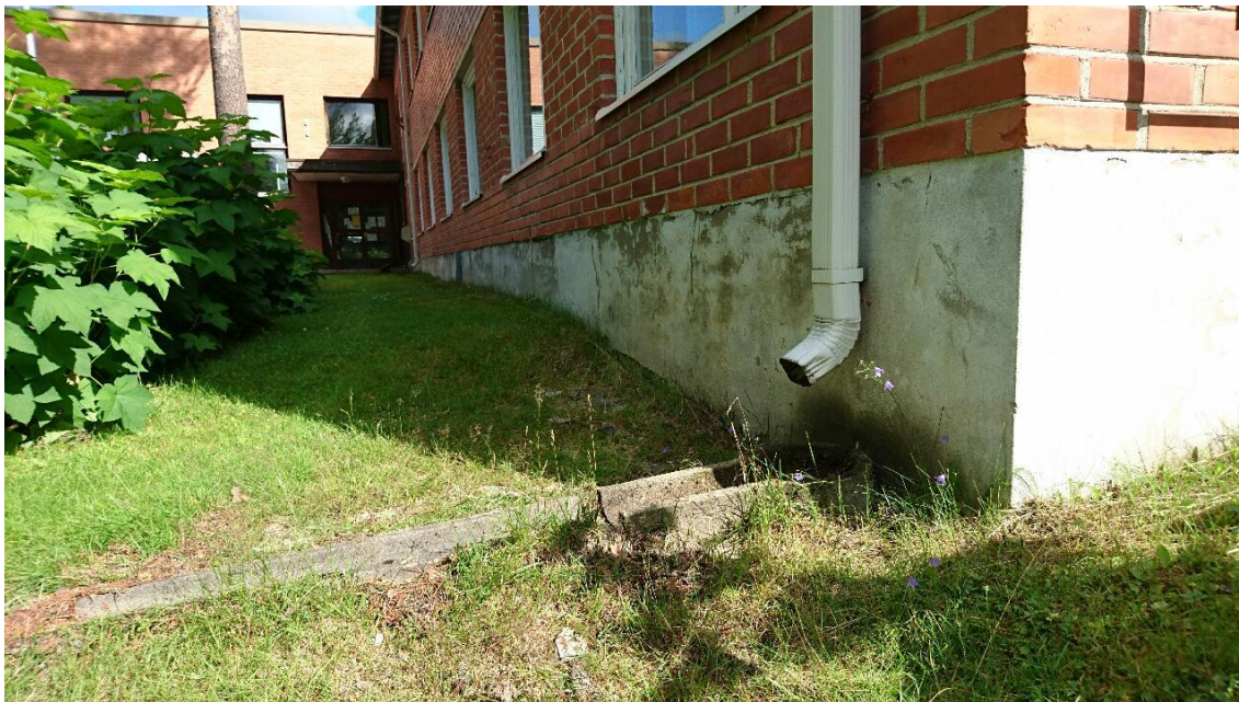
Kuva 1. Sadevedet pääsevät valumaan perustuksiin eteläpään kulmassa.
