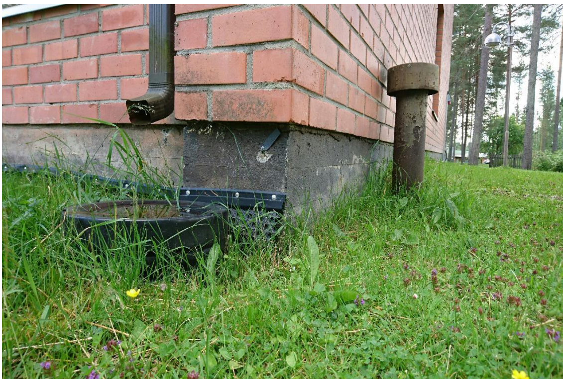
Kuva 2. Sadevedet pääsevät valumaan perustuksiin pohjoispään kulmassa ja sitä myöten tuuletusputkea pitkin arkistoon.
