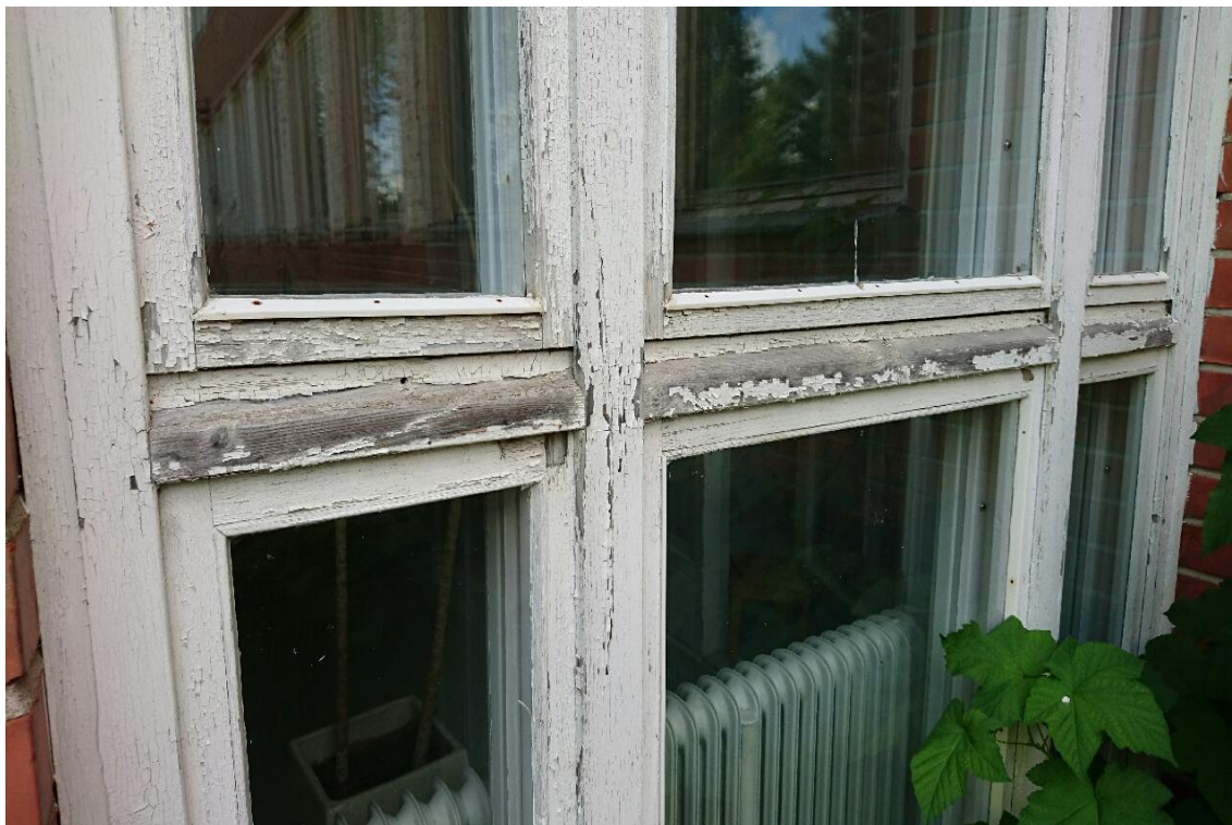
Kuva 5. Eteläpään käytävän ikkunarakenteiden maali on hilseilyt.
