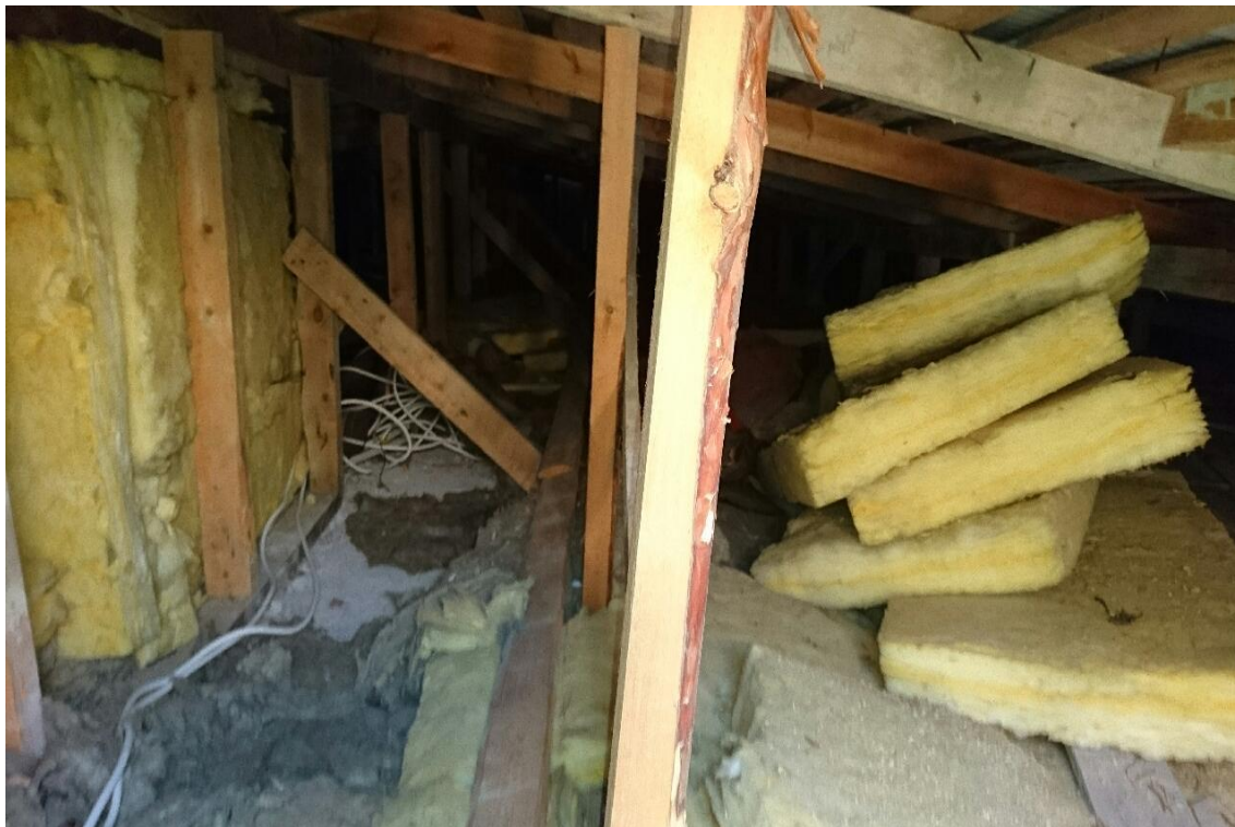
Kuva 3. Vanhan osan yläpohjan mineraalivillat ovat pois paikoiltaan.
