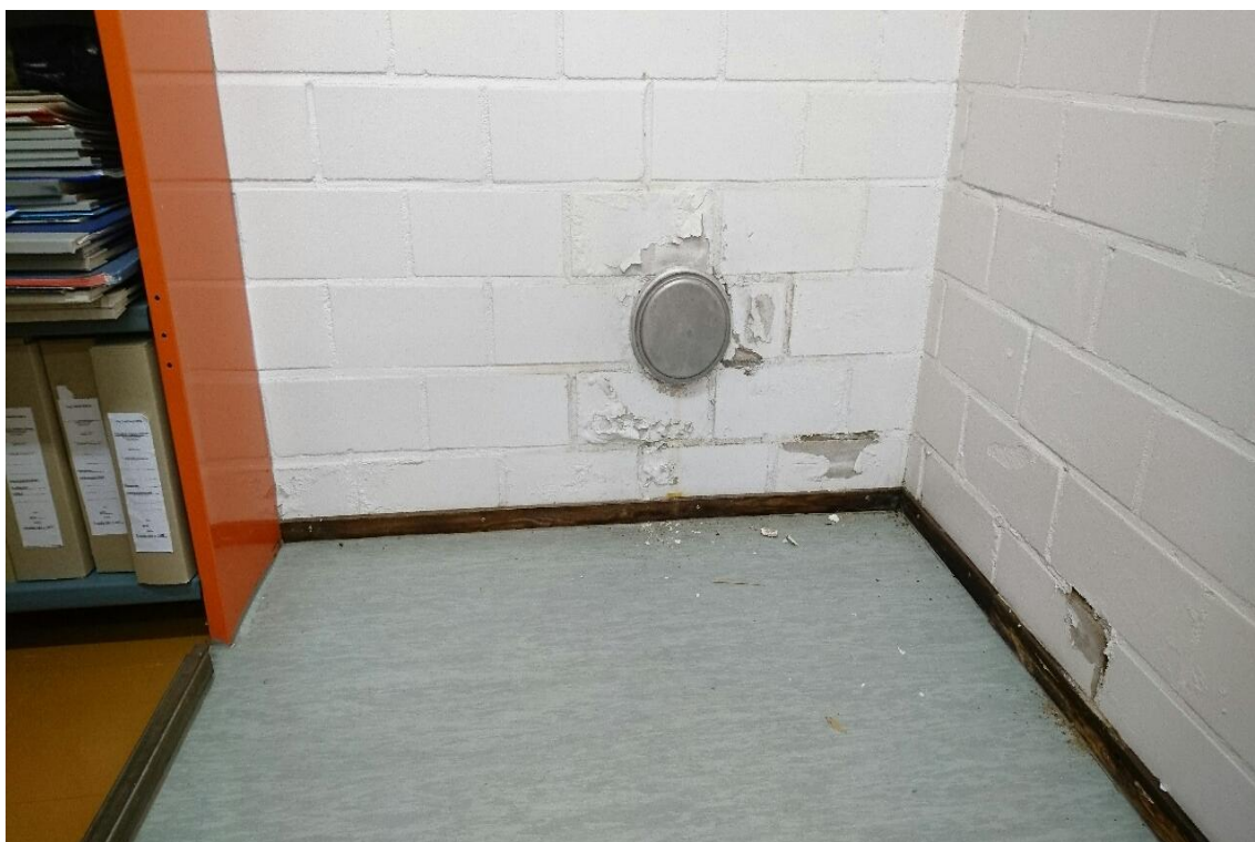
Kuva 8. Arkiston tuuletusputken ympäryksellä on vuotanut sade- ja sulamisvedet sisälle.
