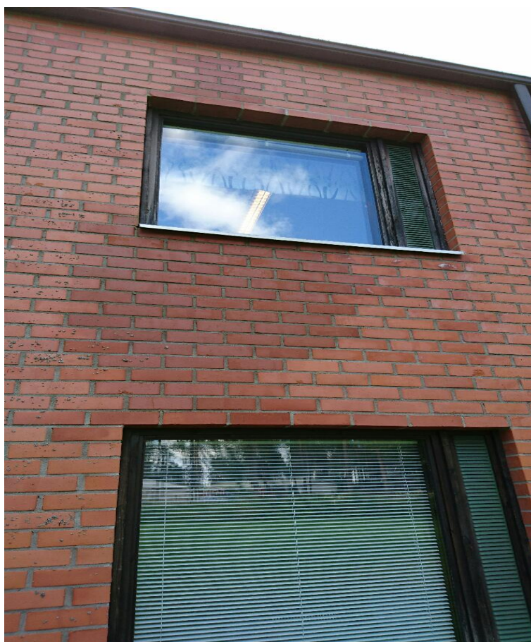
Kuva 14. Sadevesi on päässyt valumaan räystääskourun yli laajennusosan pohjoispuolella ja kastellut seinää.
