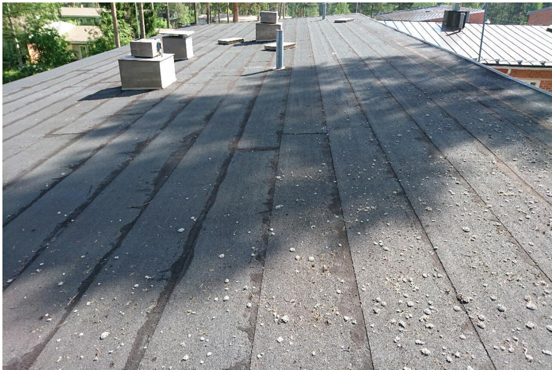
Kuva 11. Laajennusosan vesikate on huono.
