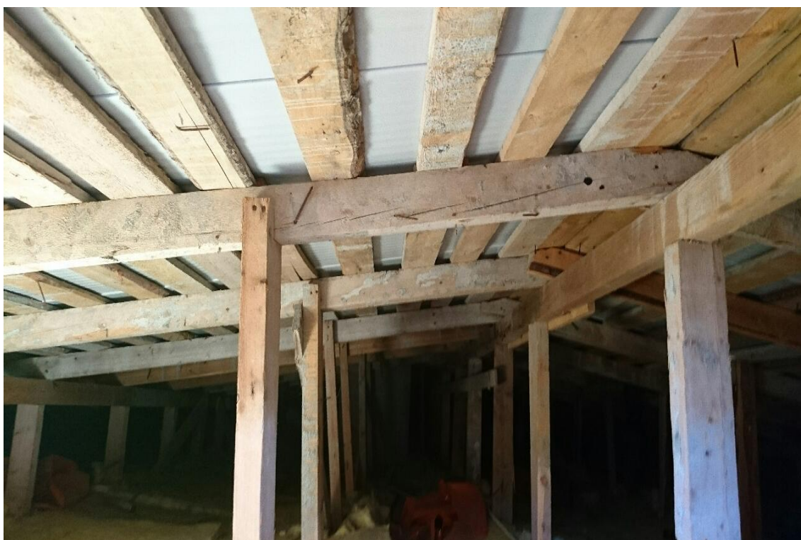
Kuva 10. Vanhan osan katto ullakolta, missä on havaittavissa aluskatteen puuttuminen.
