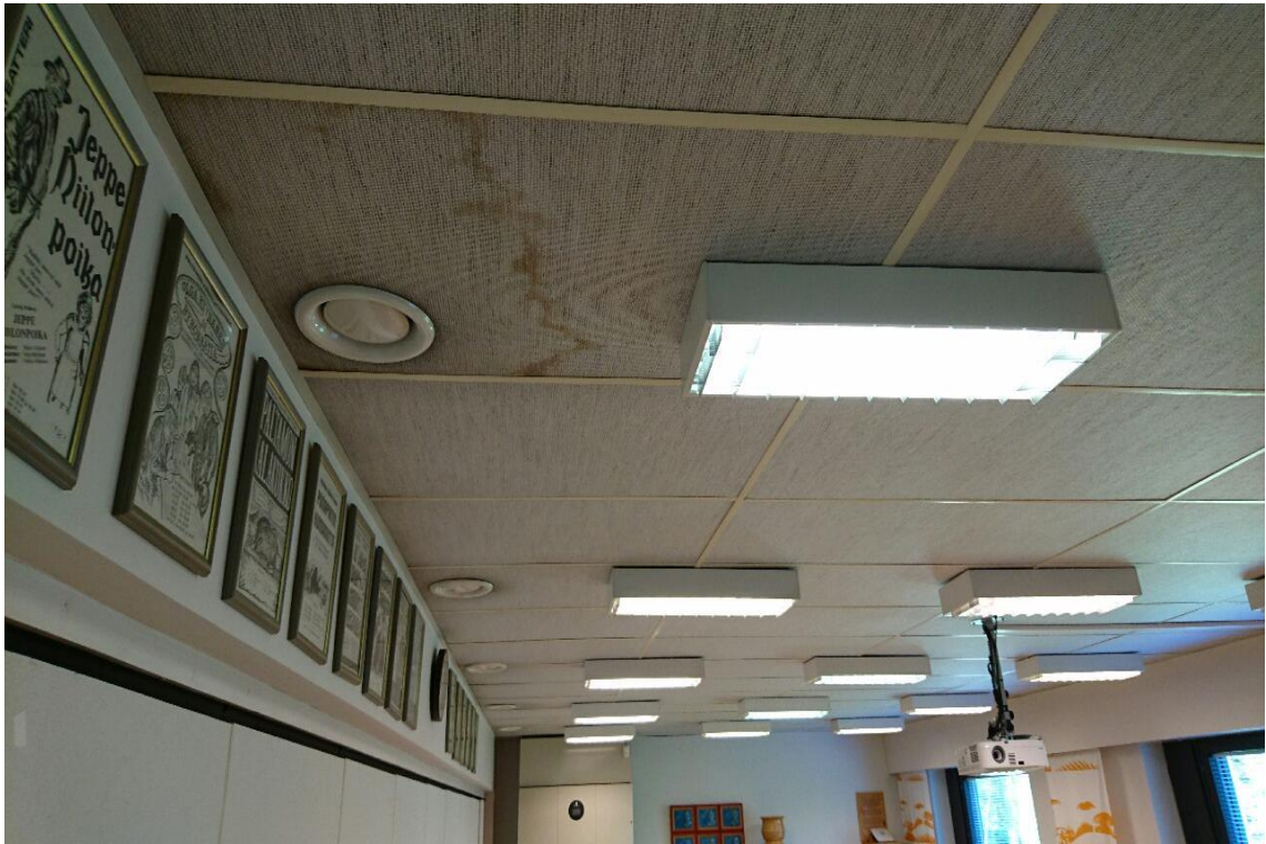
Kuva 15. Valtuustosalin katossa on ilmastointiputken ympärys kastunut.
