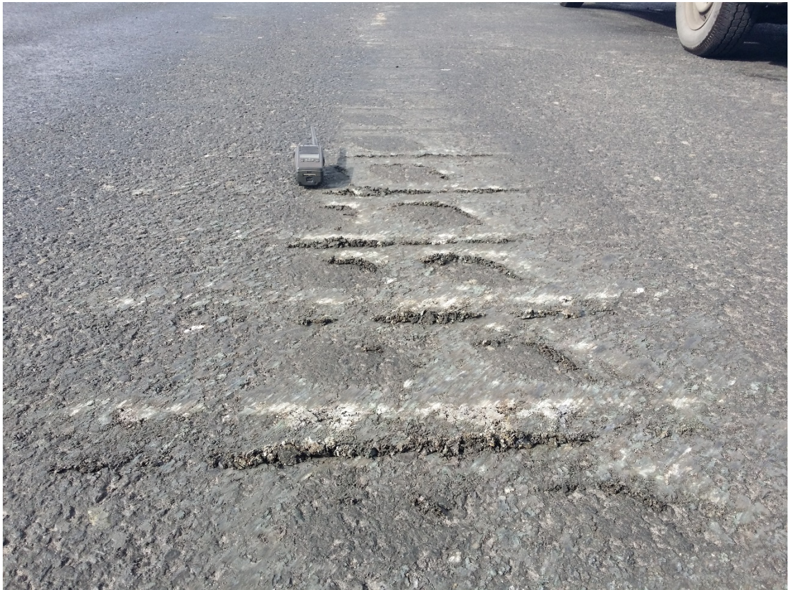
Kuvio 19. Sennebogenin telan aiheuttamia vaurioita päällysteessä
