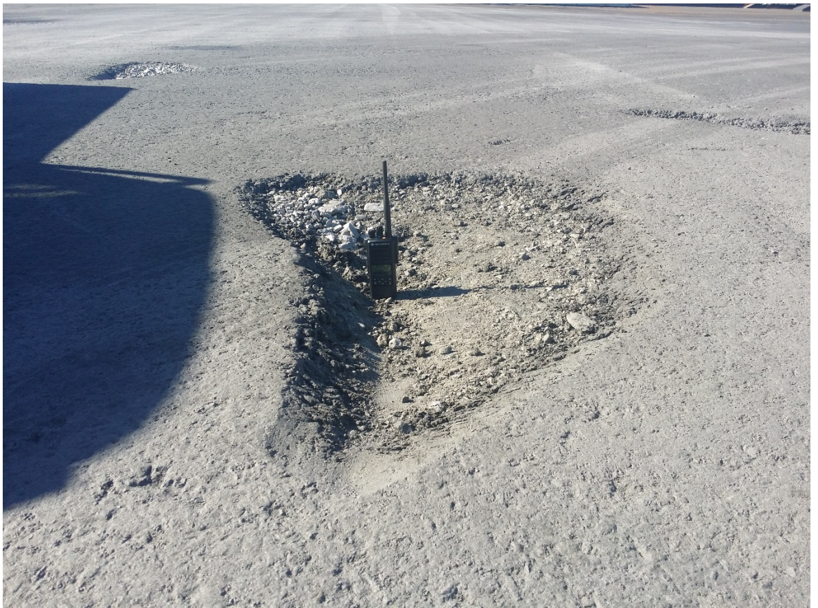
Kuvio 17. Kauhan aiheuttama vaurio päällysteessä
