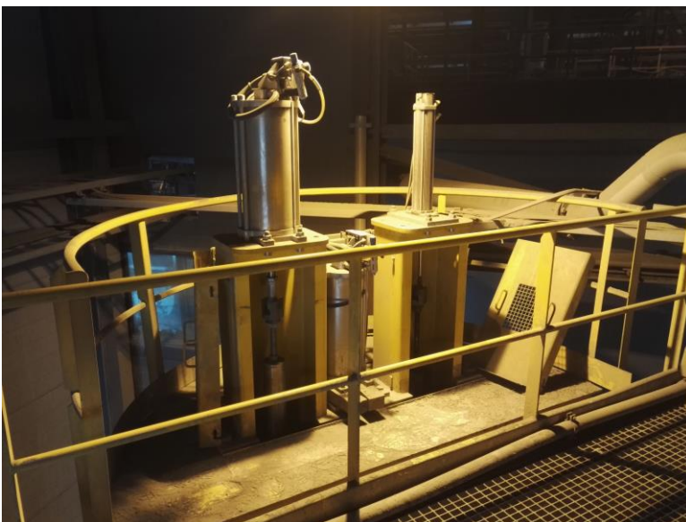
KUVA 11. DART-venttiilien toimilaitteet perälaatikon päällä
