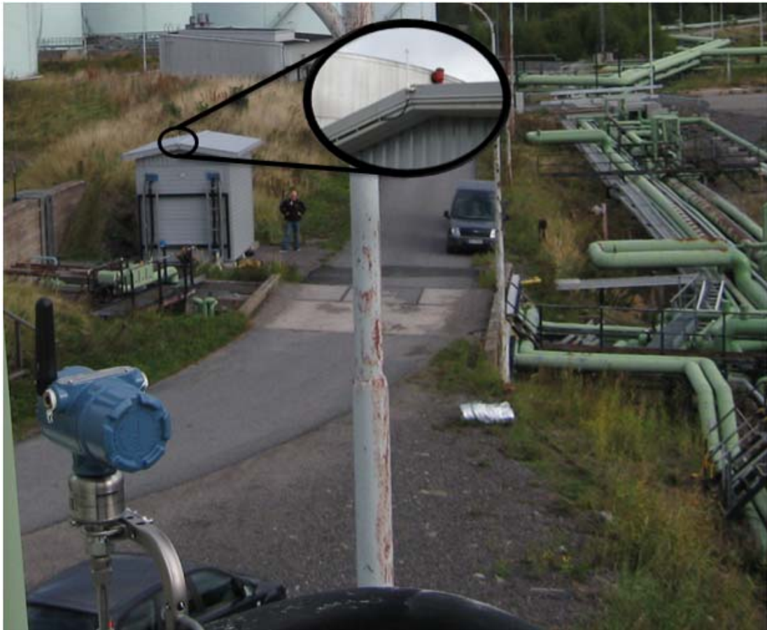
Kuva 7. Panielähetin PT-9005 ja tekninen tila, jonka katolla gateway-yksikön antenni
