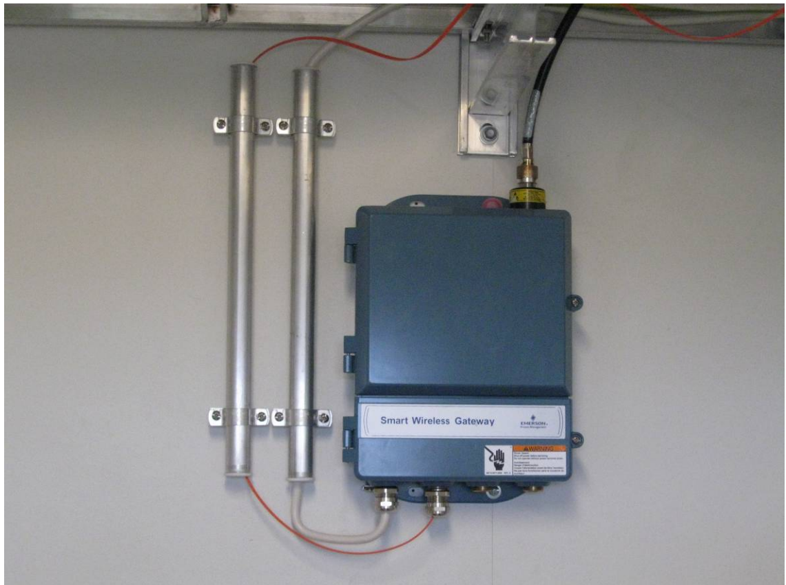
Kuva 8. Gateway-yksikkö asennettuna tekniseen tilaan AB-143
