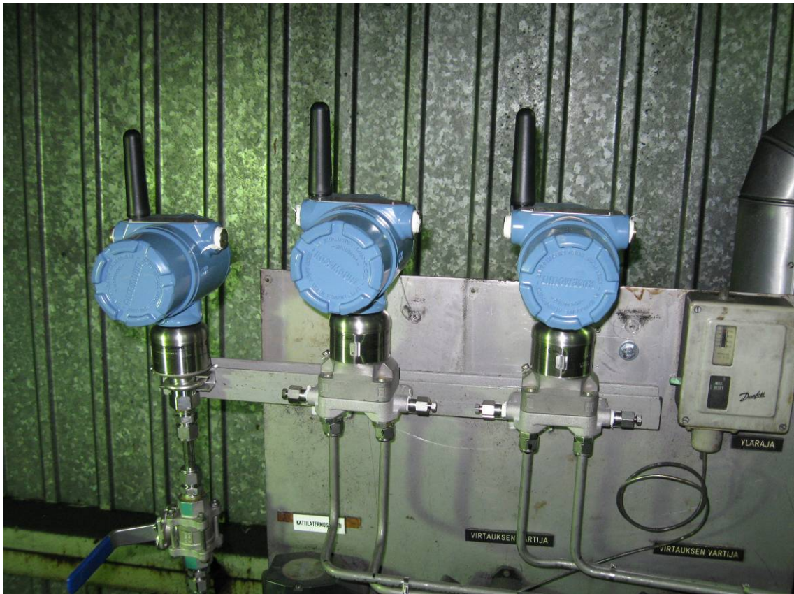
Kuva 6. Imupaineen ja tuubivirtauksien paine-erojen lähettimet
