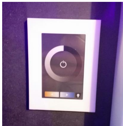
Kuva 10. Aura Light DALI-Touchpanel Valo/on 2017-messuilla 01.02.2017.
