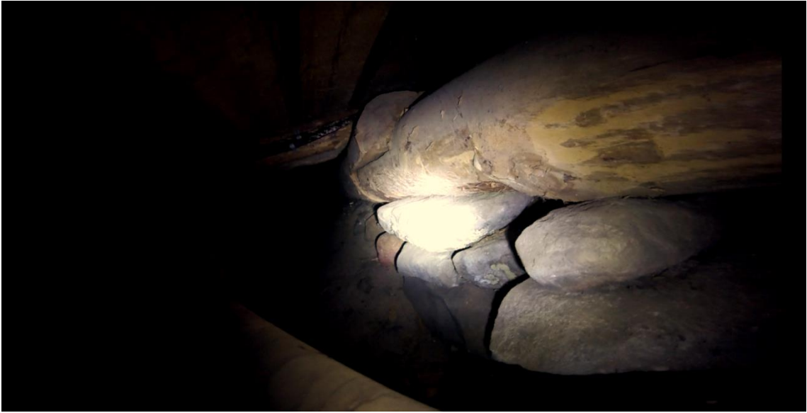
KUVA 18 Kirkon alapohjan lattiahirren liitoksen siirtymä
