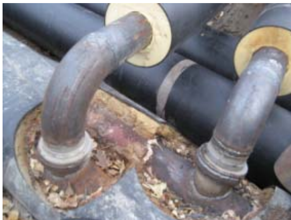
Kuvio 5: Eristeen ja putkien väliin on kertynyt roskaa.
