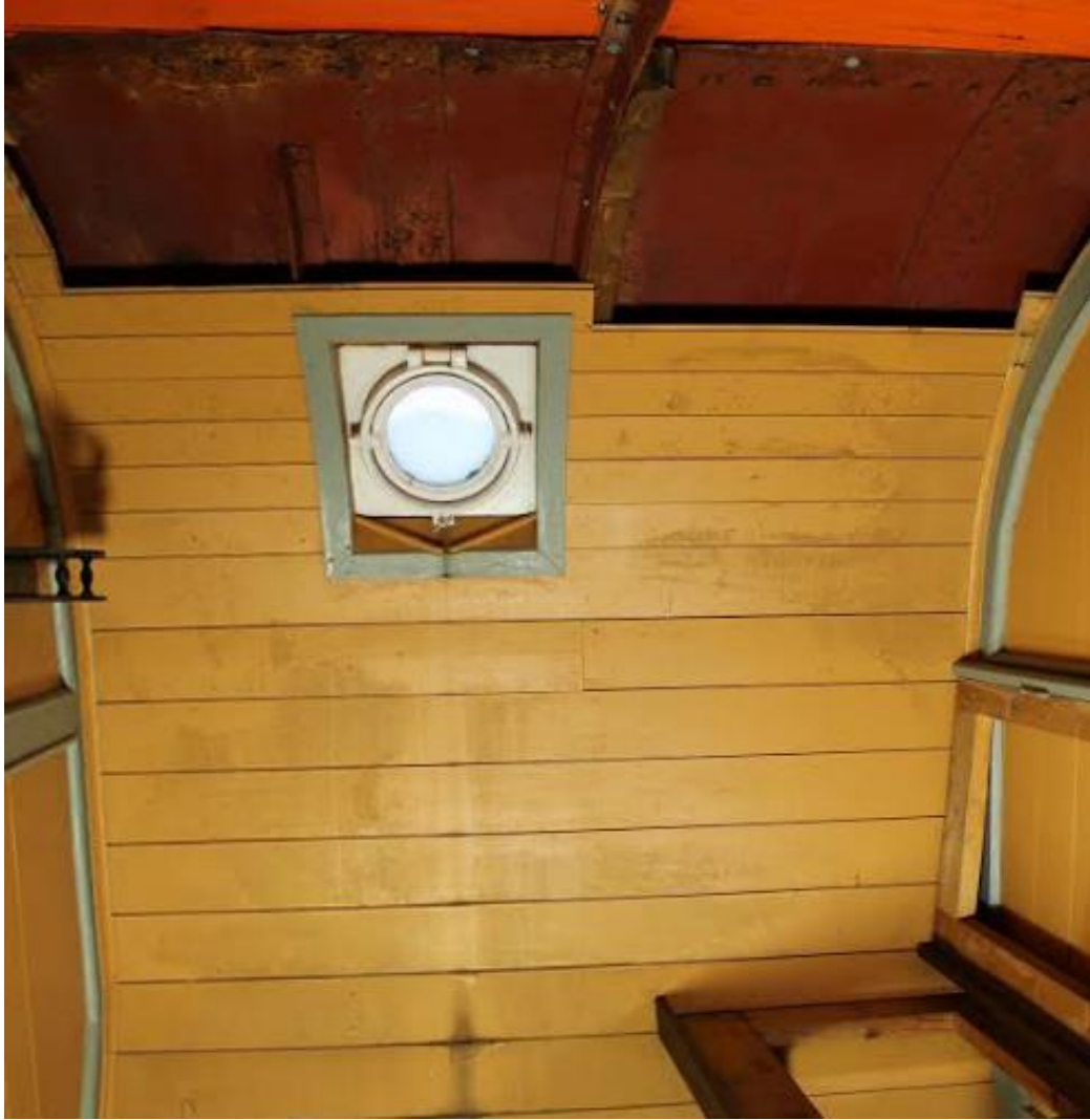
Kuva 10. Hytin panelointi puuttuu seinän yläosasta, jonka takia punainen kylki- ja kattorakenne näkyvät. (Meinander 2016)
