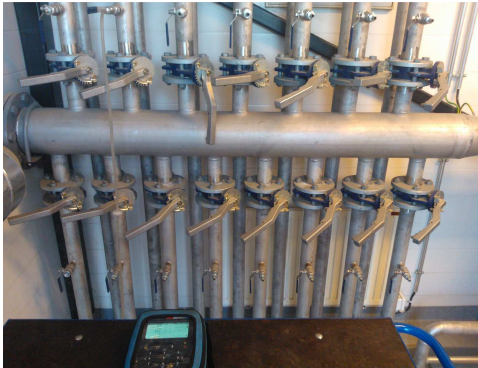
Kuva 2. Kaatopaikkakaasunkeräysjärjestelmän imulinjat liitettynä imutukkiin biokaasupumppaamolla ja siirrettävä kaasuanalysointilaitteisto kaasunpitoisuuksien mittaukseen. [3]
