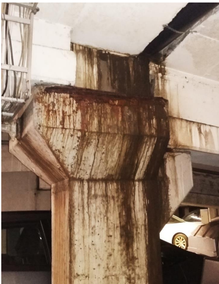
KUVA 19. Ruostuneiden rakenneosien aiheuttama esteettinen haitta
