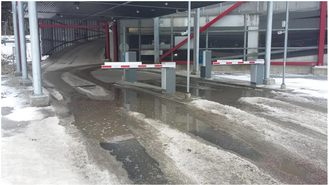
KUVA 16. Toimimaton vedenpoisto puomialueella
