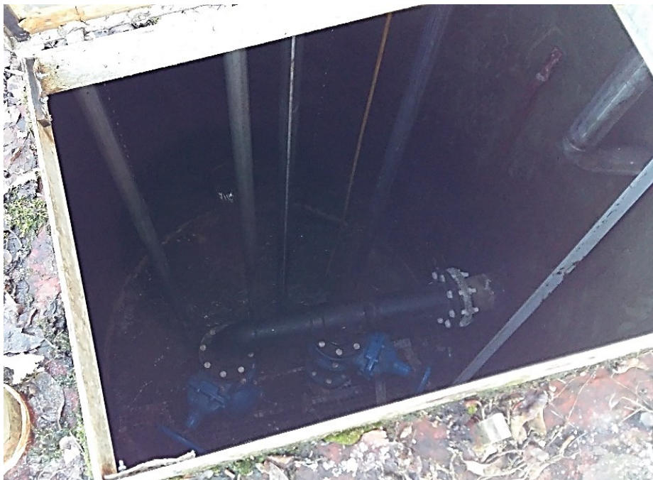
Kuva 33. Tuusulantien jätevesipumppaamon pumppaamosäiliö.
