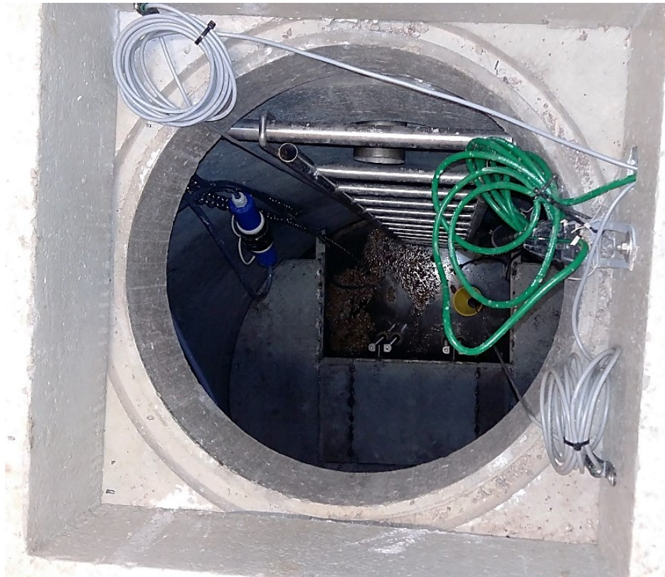
Kuva 30. Pumppusäiliö Virrenkulman jätevesipumppaamossa.
