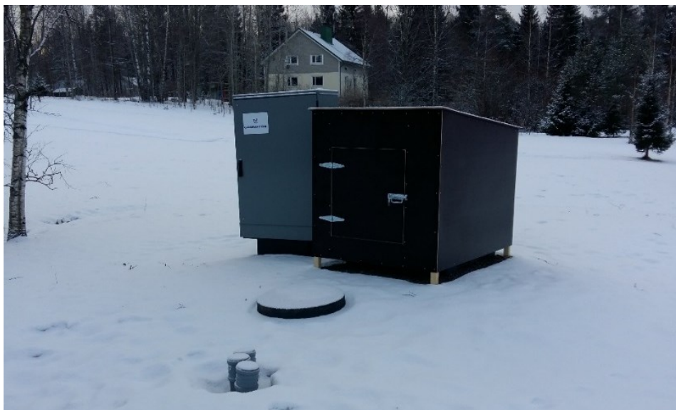
Kuva 31. Jokitien pumppaamon sähkökeskus ja kemikaalinsyöttösäiliö.
