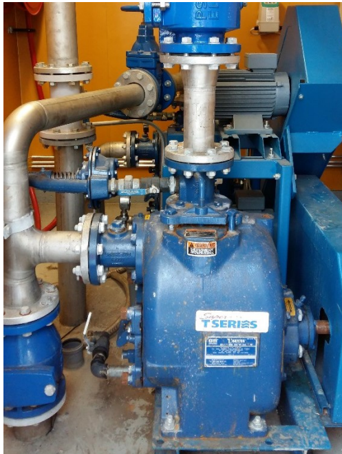
Kuva 39. Laineentien pumppaamon itseimevät pumput.
