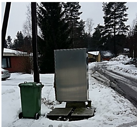
Kuva 41. Luotolantien jätevesipumppaamon sähkökaappi ja huoltoluukut.
