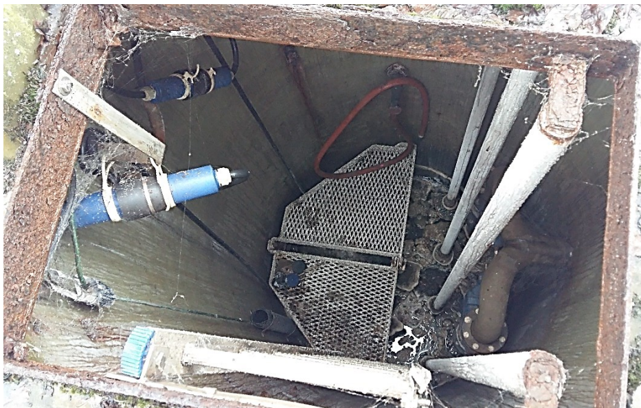
Kuva 40. Luotolantien jätevesipumppaamon sisäpuoli.
