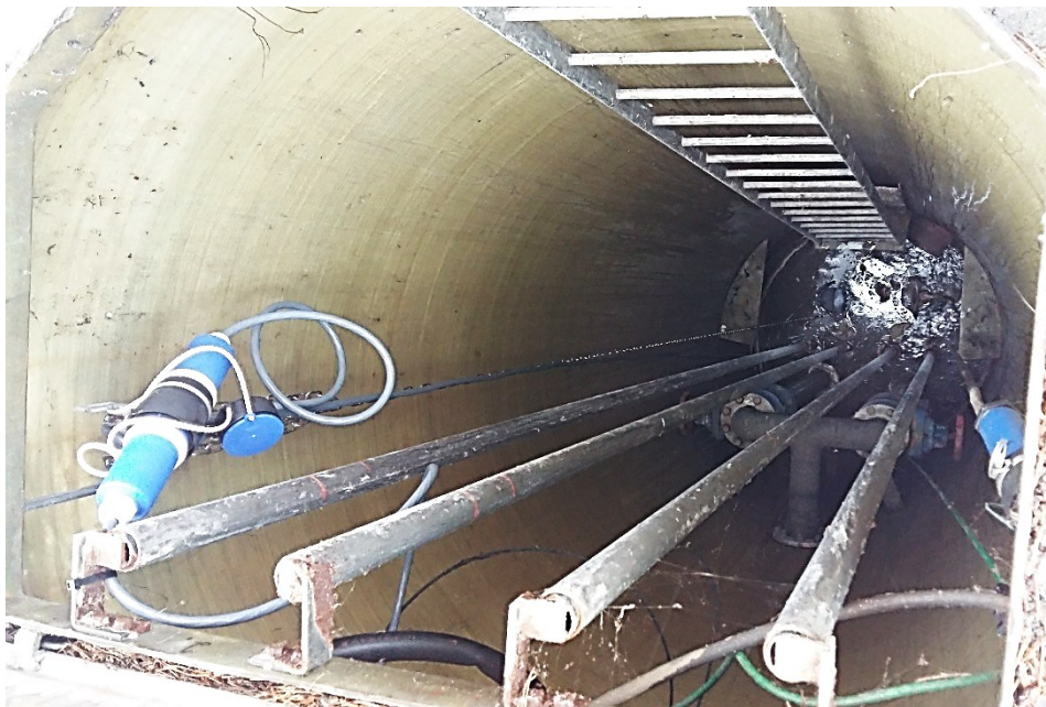
Kuva 37. Liesitien jätevesipumppaamon pumppaamosäiliö.
