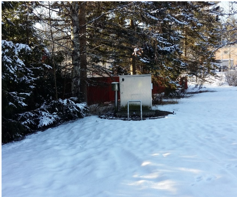
Kuva 38. Pihkaniityn jätevesipumppaamon huoltoluukku ja sähkökeskus.
