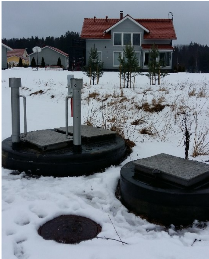
Kuva 32. Etelä-Savion pumppaamon huoltoluukut.
