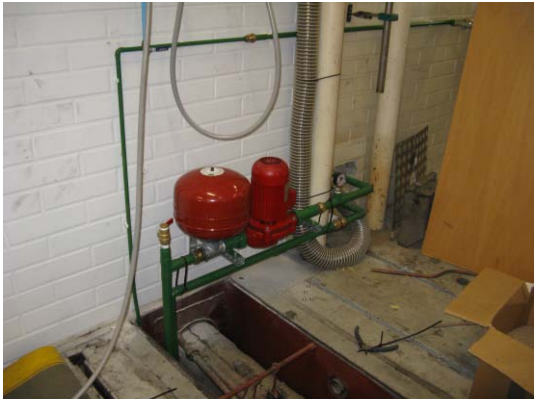
Kuva 18. Lauhdutinlinjan paisuntasäiliö ja pumppu.
