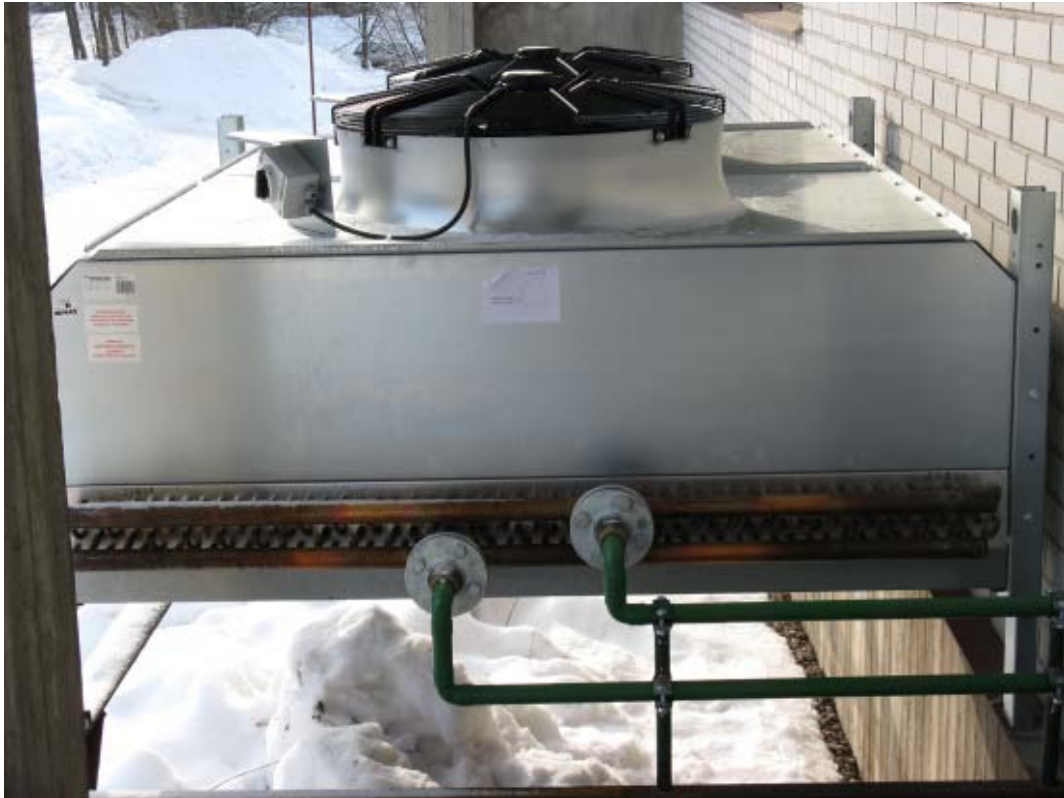
Kuva 16. Lauhdutin asennettuna telineeseensä.
