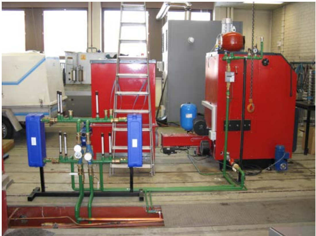
Kuva 13, Kattila ja lämmönsiirtimet asennettuna.
