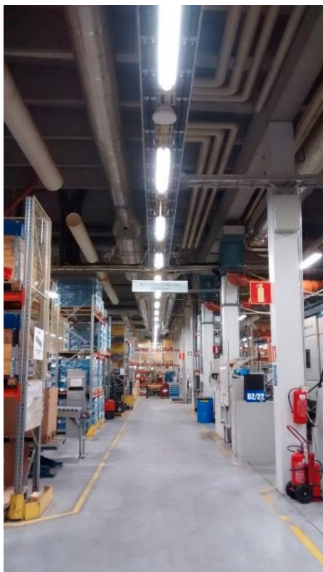
KUVA 4. Loisteputkilla valaistu kulkuväylä (Rummukainen 2017-03-30.)
