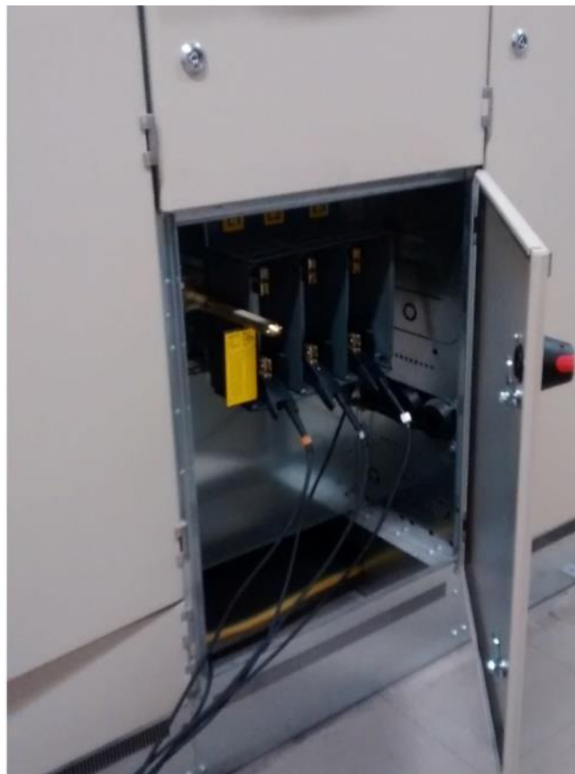
KUVA 7. Jännitekytkentä toteutettuna varokeytikimen virtakiskoista (Rummukainen 2017-04-05.)
