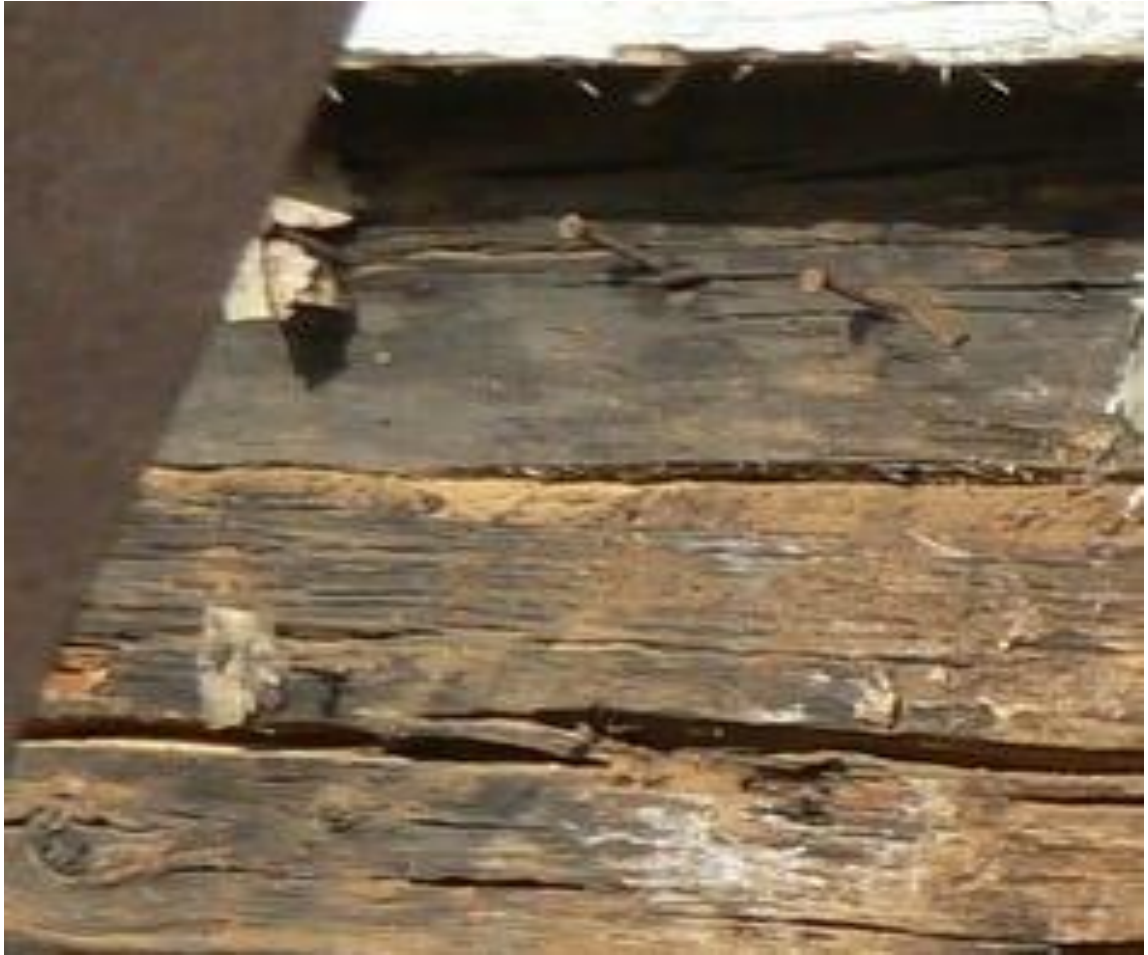
Kuva 17. Vaurioitunut hirsirakenne tervapaperin alla.
