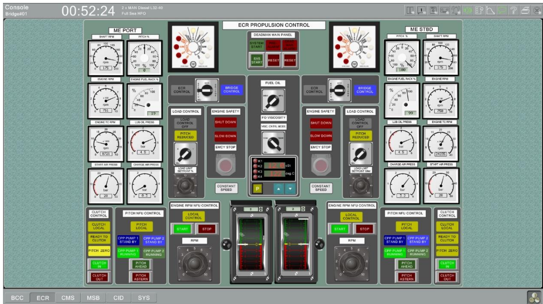
Kuva 29. Konevalvomon propulsiionhallintajärjestelmä (Salminen)
