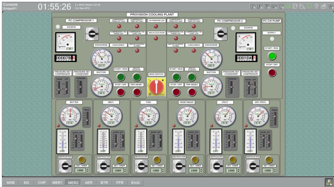
Kuva 36. Proviantikompressoreiden käyttöpaneeli (Salminen)
