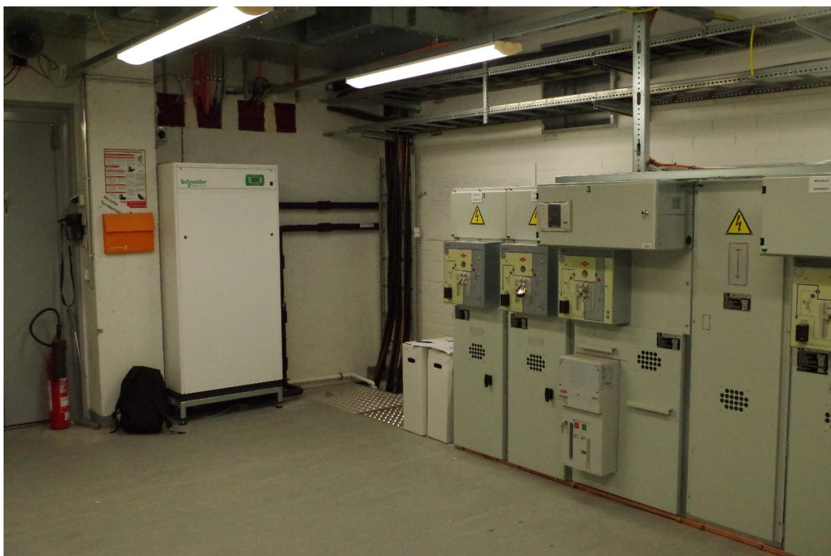
KUVA 5. Sähkötila ja sen varusteita (Määttä, 2017.)
