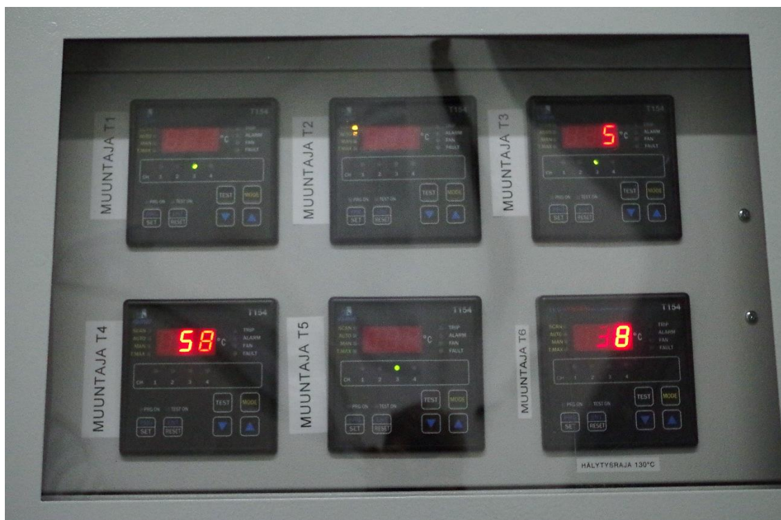
KUVA 14. Kuivamuuntajien lämpötilanvalvontayksikkö (Määttä, 2017.)
