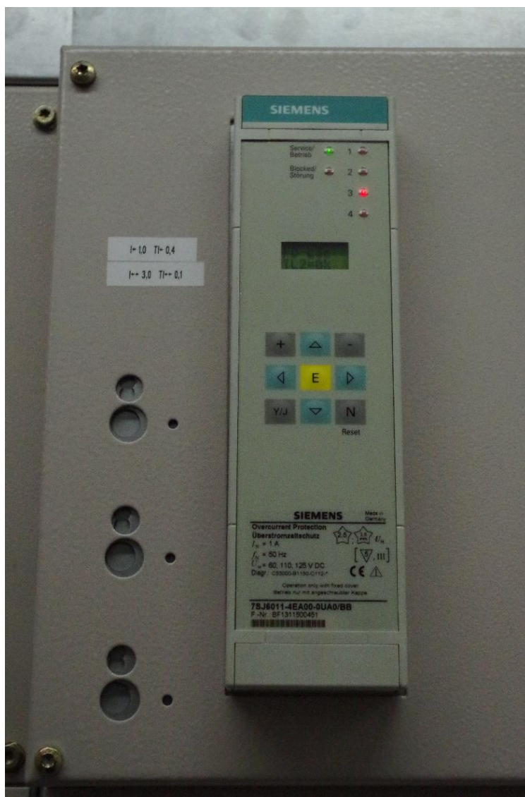
KUVA 7. Siemens Siprotec-sarjan ylivirtasuojarele (Määttä, 2017.)
