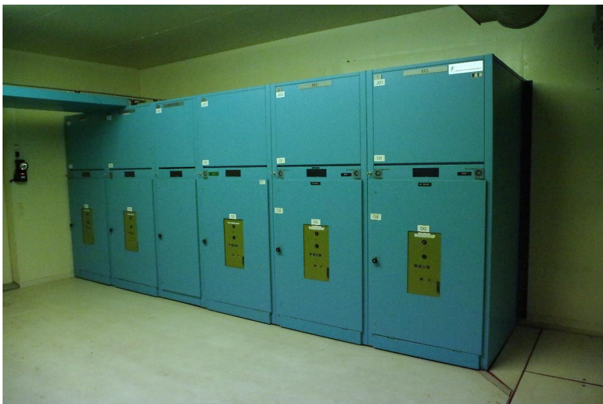
KUVA 4. Sähköliikkeiden Oy:n valmistama vanha 12 kV kojeisto vuodelta 1982 (Määttä, 2017.)
