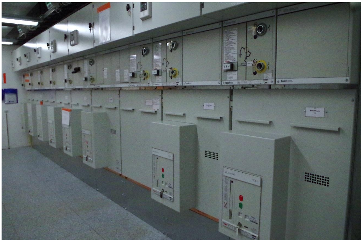
KUVA 13. Tozzi Electrical Equipment ilmaeristeinen keskijännitekojeisto (Määttä, 2017.)
