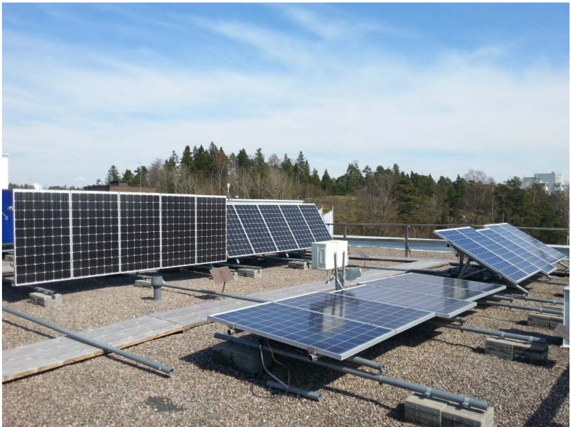
Kuva 7. MetroSol-järjestelmän aurinkopaneelit asennettuna Leppävaaran toimipisteen katolle eri kallistuskulmiin (5°, 40°, 60°, 90°).
