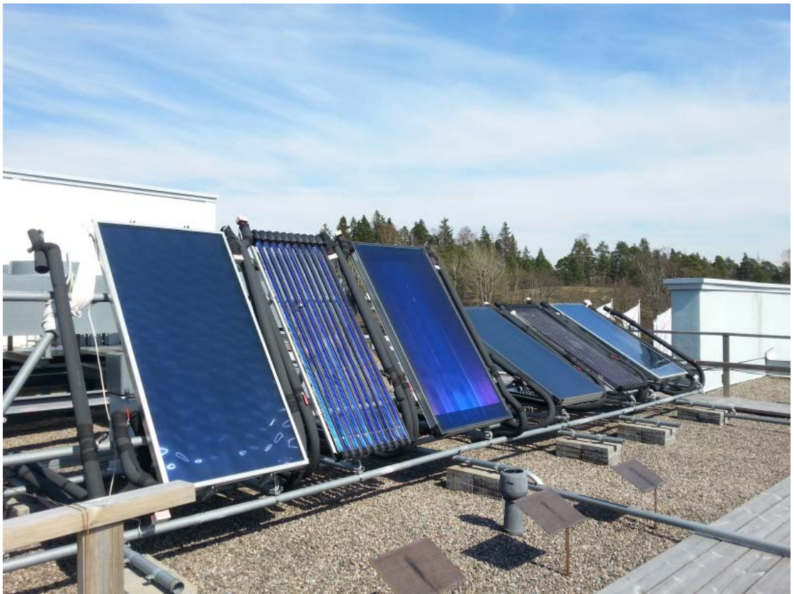
Kuva 8. MetroSol-järjestelmän aurinkokeräimet asennettuna toimipisteen katolle eri kallistuskulmiin (30°, 60°).
