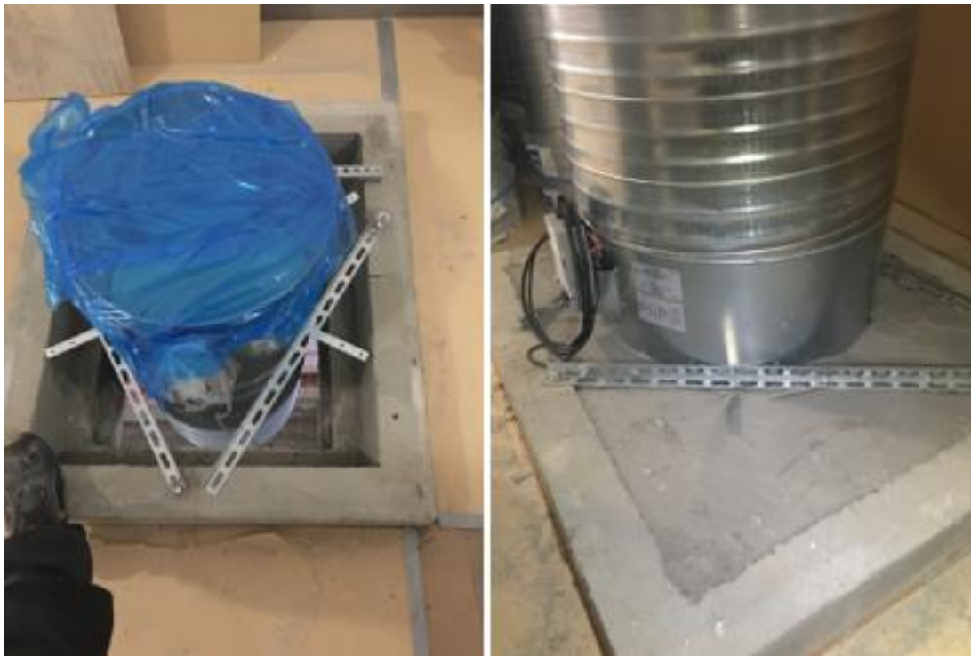
Kuva 2. Ilmanvaihtokanavan läpivienti, jossa on tarve palokatkolle. Kuva on esimerkkikohteesta.
