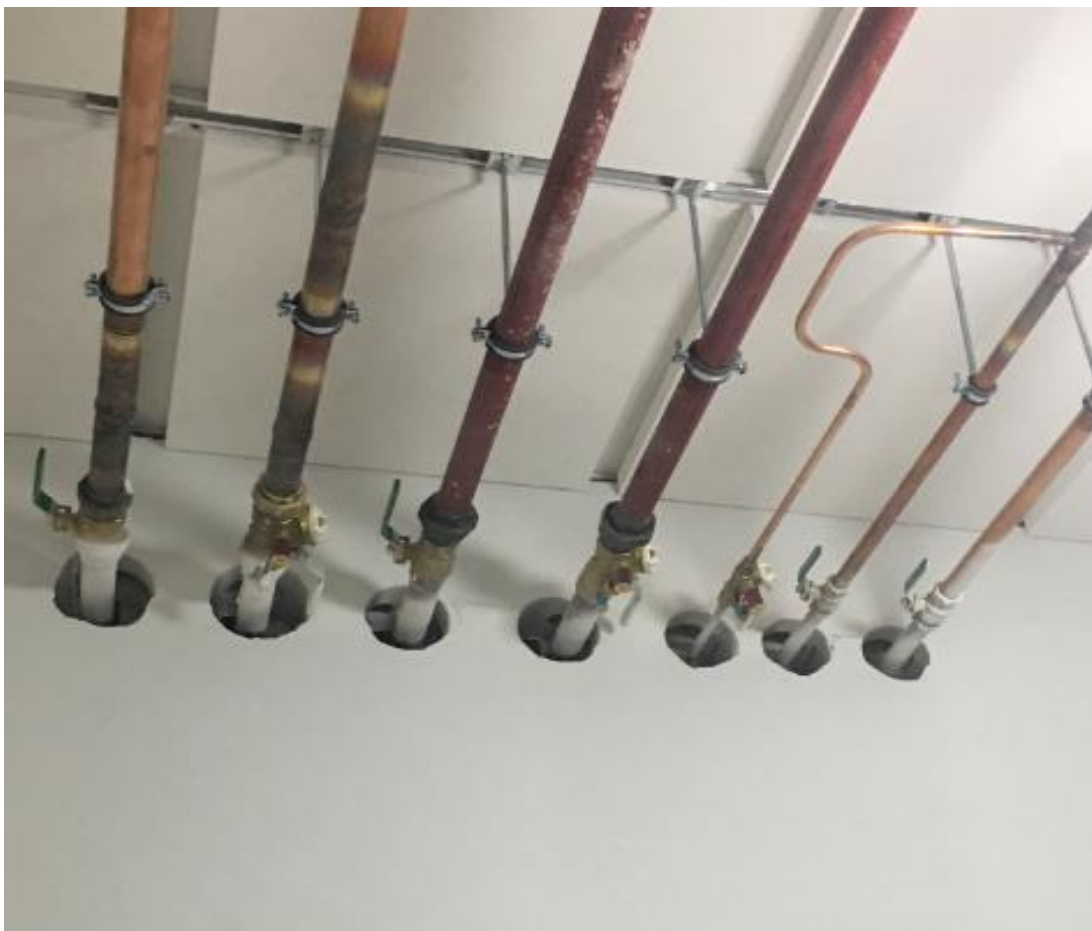
Kuva 1. Lämmitys- ja jäähdytysputket sekä käyttövesiputket. Kuva on pilottikohteesta.
