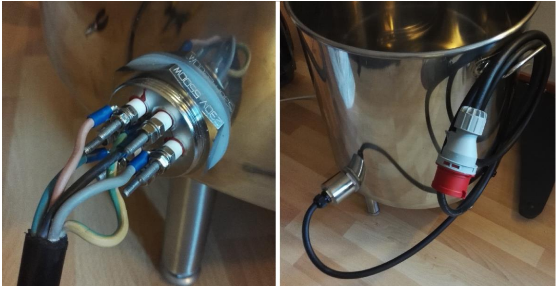
Kuva 3. Vasemmalla lämmitysvastuksen tähtikytkentä keittokattilassa. Oikealla valmis liittäjä kolmivaihepistotulpalla
