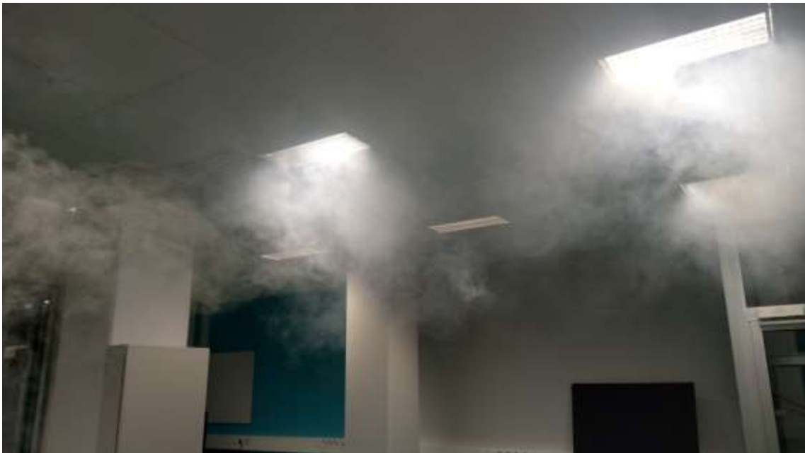
KUVA 22. Tuloilman jakaantumisen testaaminen savukokeella (kuva: Heikki Loukusa 12.12.2016)
