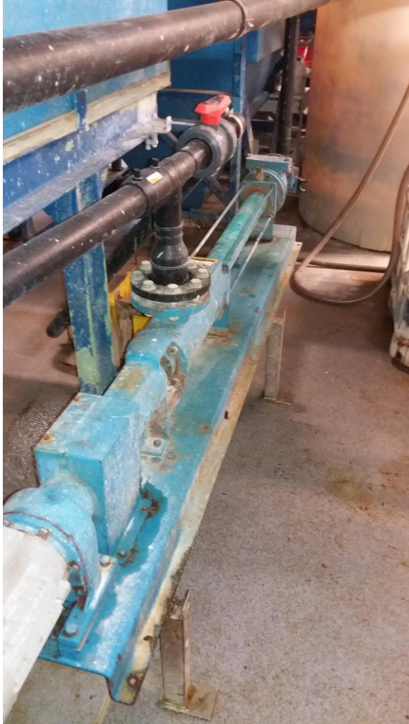
KUVA 5. Prässipumppu (Kuva: Kalle Koikkalainen 2017)
