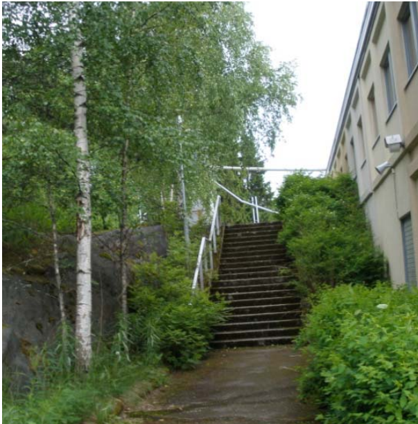
KUVIO 9. Sammaleiset portaajat sekä routavaurioinen asfaltti B-rakennuksen takana (Inventointikuvat 2009).
