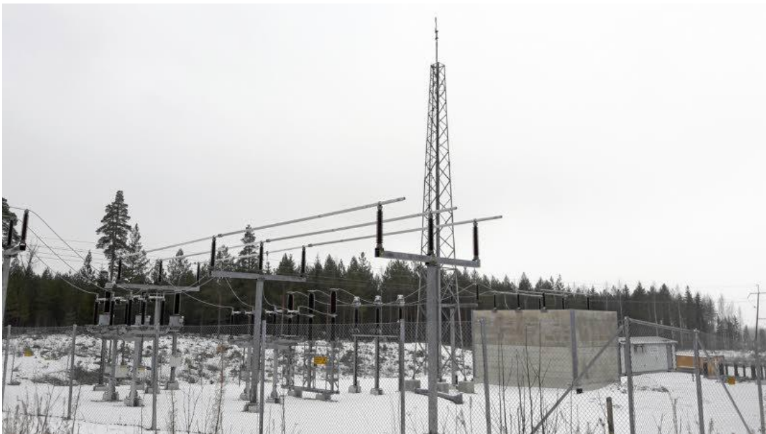
KUVA 4. Ilmaaristeinen ja avorakenteinen kytkinlaitos (9)
