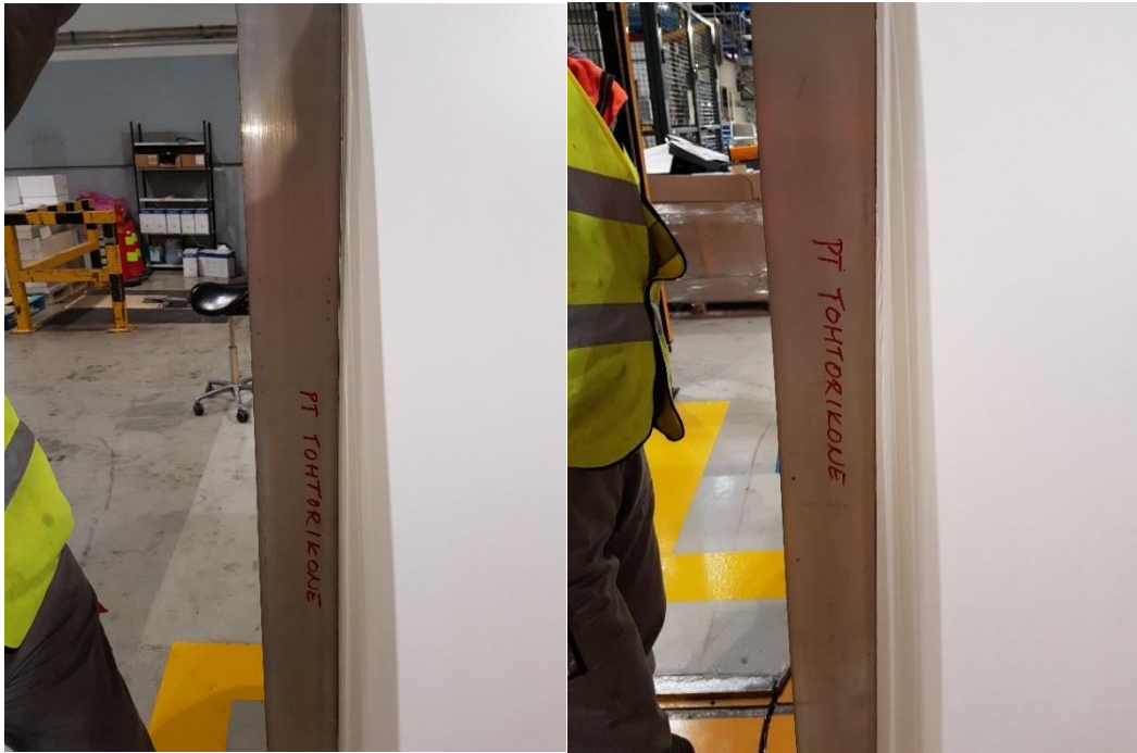
Patapäisyys heittojen korjauksen jälkeen
