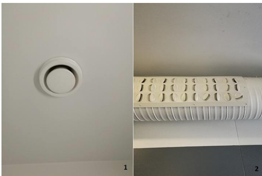
KUVA 5. Kuvassa vasemmalla helposti irrotettava ja puhdistettava lautasmallinen poistoilman päätelaitte ja oikealla kymmenellä ruuvilla kiinni oleva tuloilman päätelaitte
