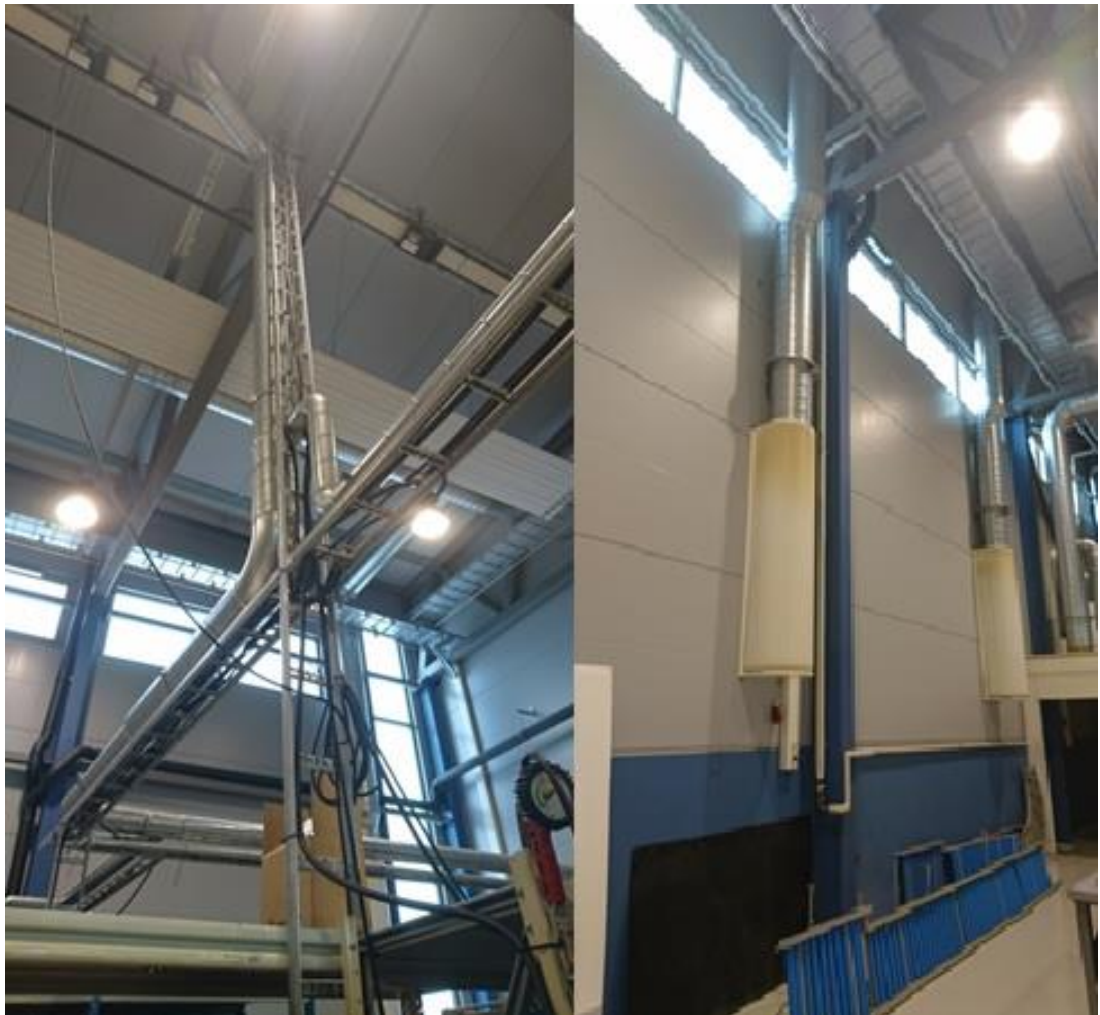
Kuvio 8. Työpisteelle tuodut kaapelit ja johdot sekä ilmastointikanava
