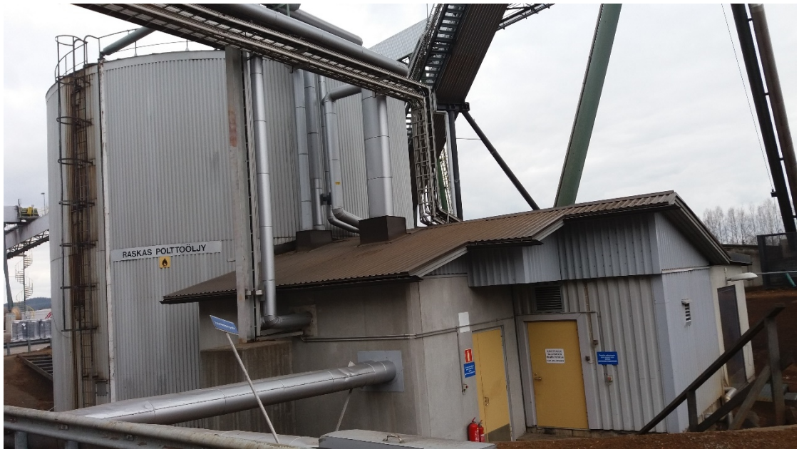
Kuvio 2. Raskaspolttoöljysäiliö ja pumppaamohuoneet
