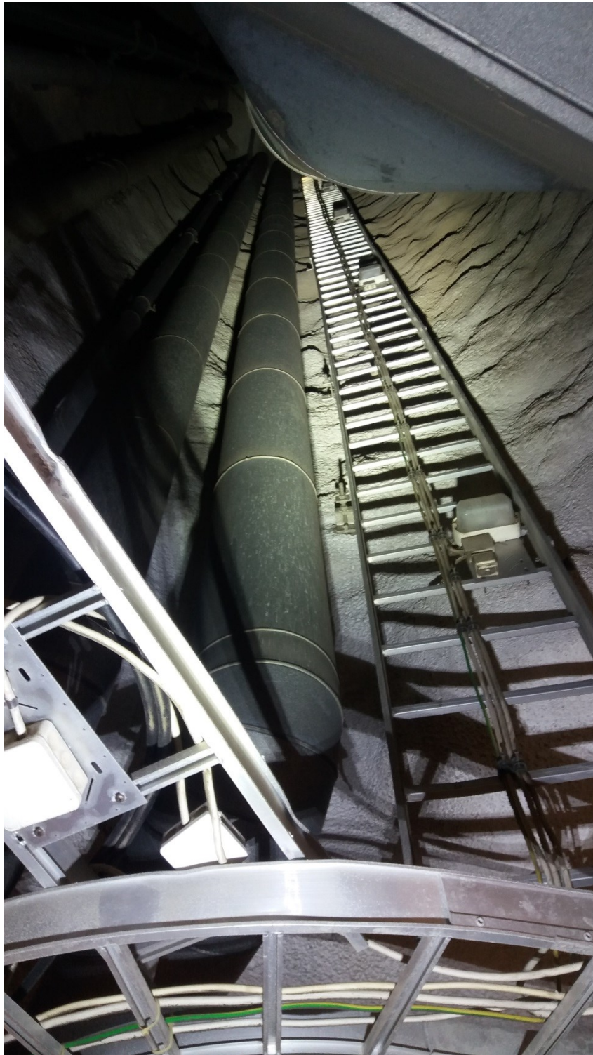
Kuva 30. Itäkeskuksen uimahallin poistoilmakuilu.
