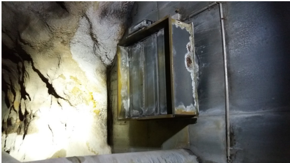
Kuva 34. Maunulan urheiluhallin tuloilmakuilun ohutpeltiset osat ovat kovalla kosteusrasituksella.
