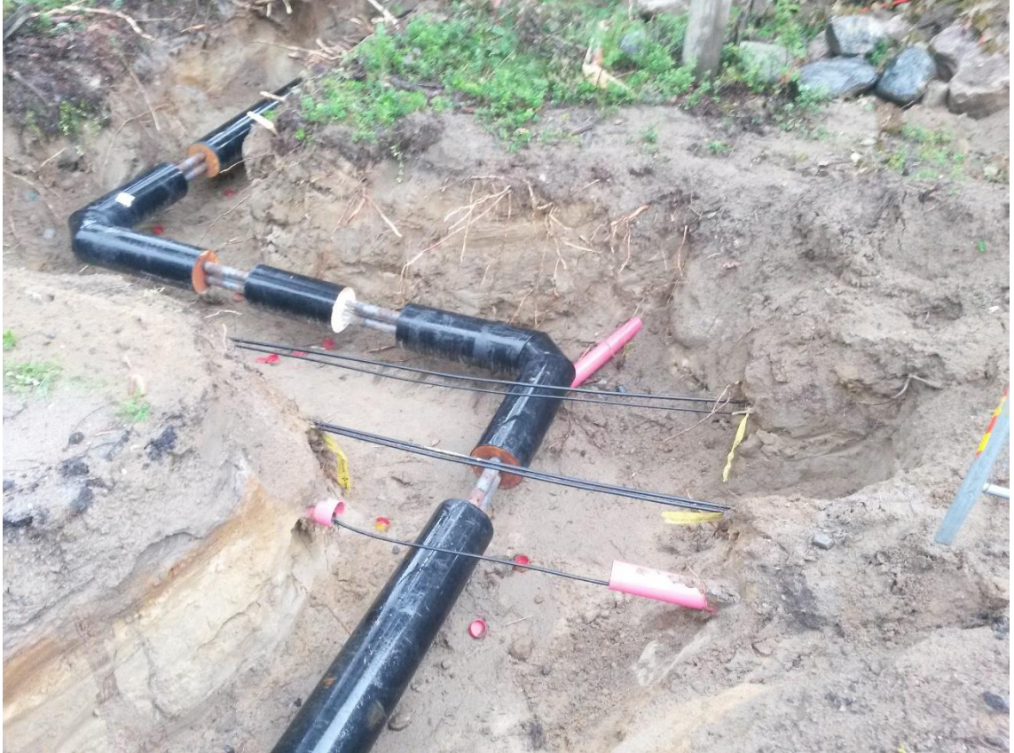
Kuva 4. Eristämätön Mpuk –linja
