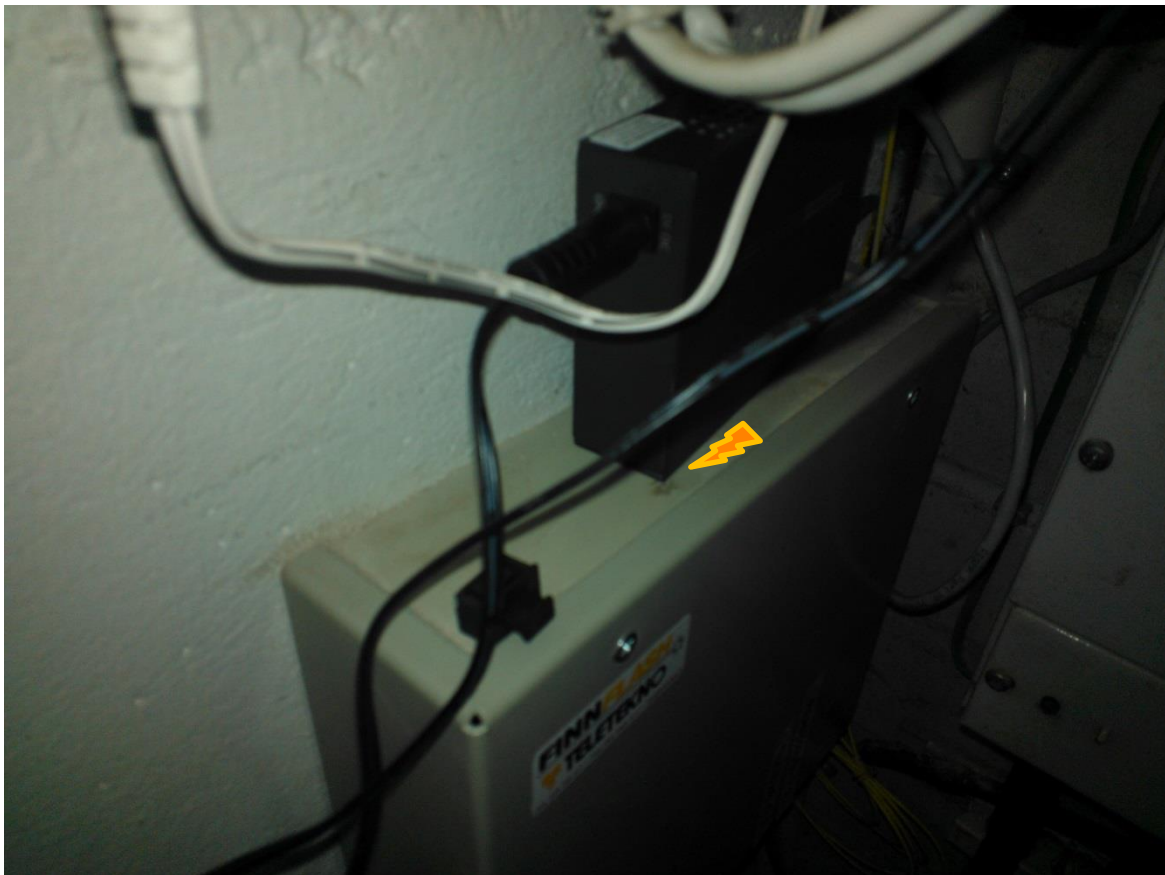
Kuva 7. Salaman aiheuttama ylijännite valokuituliitymässä. Liittymän asennuksesta puuttunut potentiaalintasaus muuhun sähköverkkoon aiheutti virtapiikin useaan eri laitteeseen. Salaman on tullut ulos mustan laitteen kulmasta ja maadoittunut valkean kytkentärasian ja valokuidun suojalankojen kautta maahan. On hyvin todennäköistä että valokuitukaapelin suojakuori on jostakin vaurioitunut salamaniskun seurauksena. Vaurion takia vettä ja likaa voi päästä kuitukaapelin sisään ja aiheuttaa myöhemmin kaapeliin vaurion.
